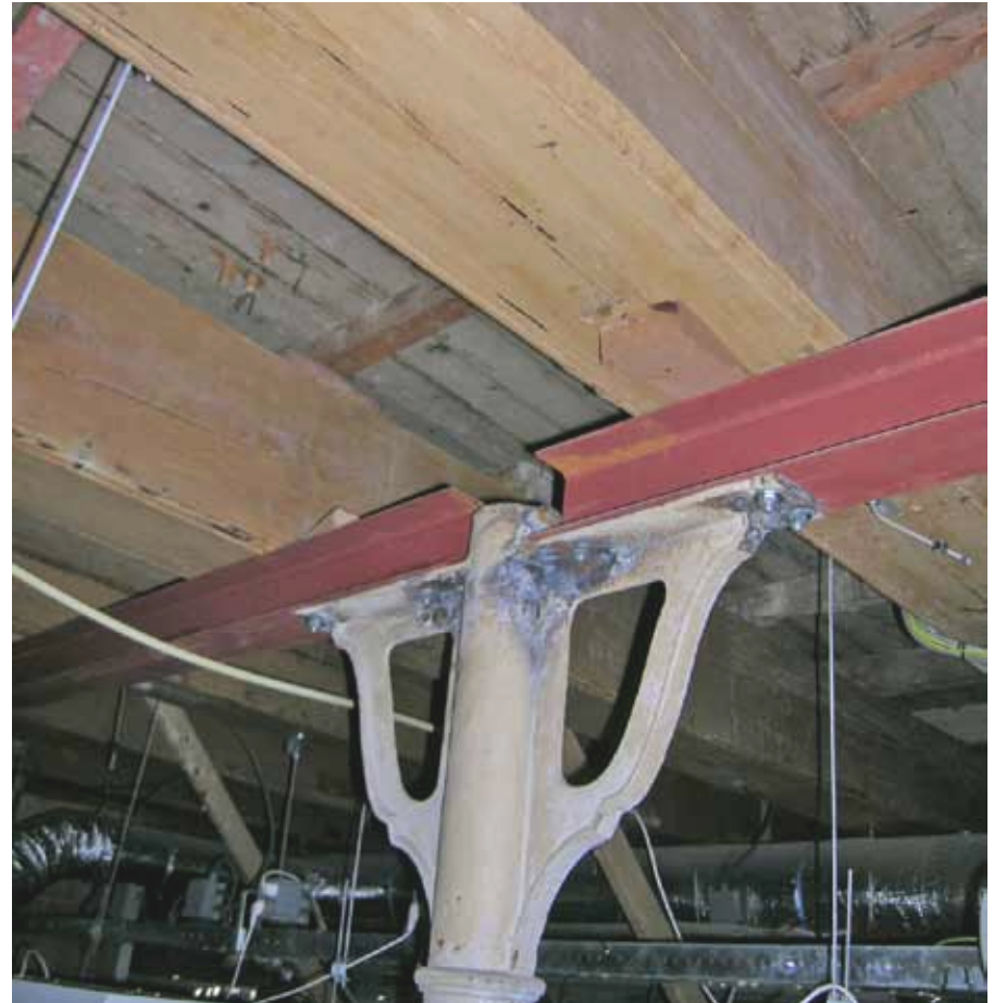
Afbeelding 70. Zicht boven het verlaagd plafond (1997) van ruimte F0.03. De gietijzeren kolommen met gelaste HE-liggers zijn vermoedelijk hergebruikt (1988).
