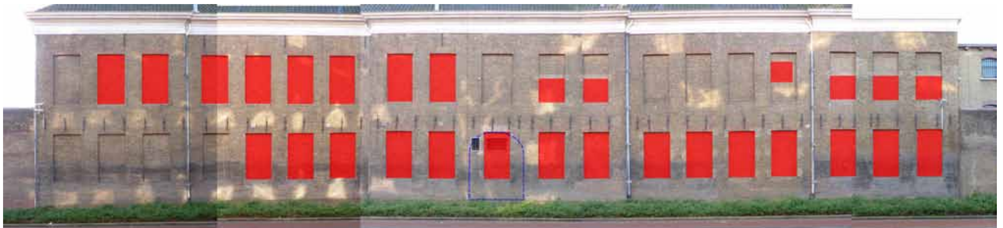
Afbeelding 7. Overzicht van de voorgevel van Bouwdeel A met daarin de dichtzettingen van de verschillende vensters sinds 1959. In het midden is de locatie van de voormalige poort gestippeld weergegeven (zie Afbeelding 8 en Afbeelding 9).
