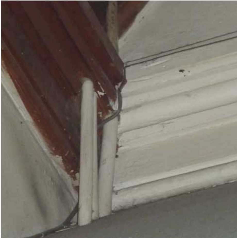
Afbeelding 78. Detail van de vorige afbeelding met de omgezette kroonlijst en de schuin daarop aansluitende voorzetwand uit de verbouwing van 1988.
