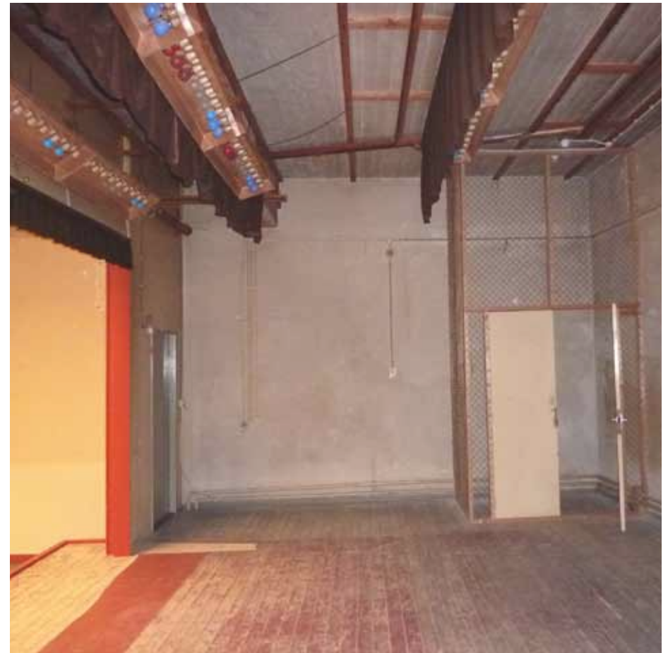
Afbeelding 110. Overzicht van de noordwand van het podium F1.05. De ruimte toont de onafgewerkte betonnen zoldervloer (1959).
