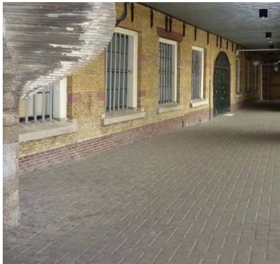
Afbeelding 122. Zicht op de binnenplaatsgevel ter hoogte van de begane grond. Deze gevel wordt thans geheel door de in 1997 aangebouwde gang aan het zicht onttrokken. De gang zou bij voorkeur verwijderd moeten worden.
