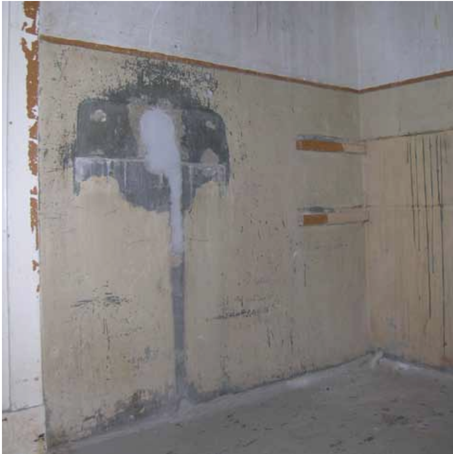
Afbeelding 62. Zicht op de wand tussen ruimte A0.14 en A0.13, gezien vanuit ruimte F0.14. De wand is voorzien van de gestucte lambrisering met de terugliggende bovenlijst (1877). Op de wand zijn sporen van een voormalige uitstortgootsteen zichtbaar.
