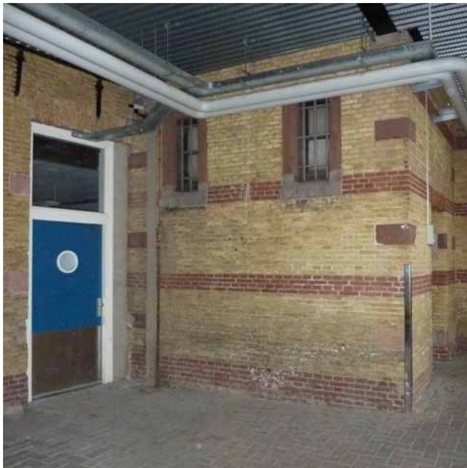
Afbeelding 30. Detail van de achtergevel ter hoogte van de begane grond. De grof vormgegeven deur naar de bibliotheek werd in 1988 ingebroken t.p.v. een venster, waartoe de borstwering uitgebroken werd.
