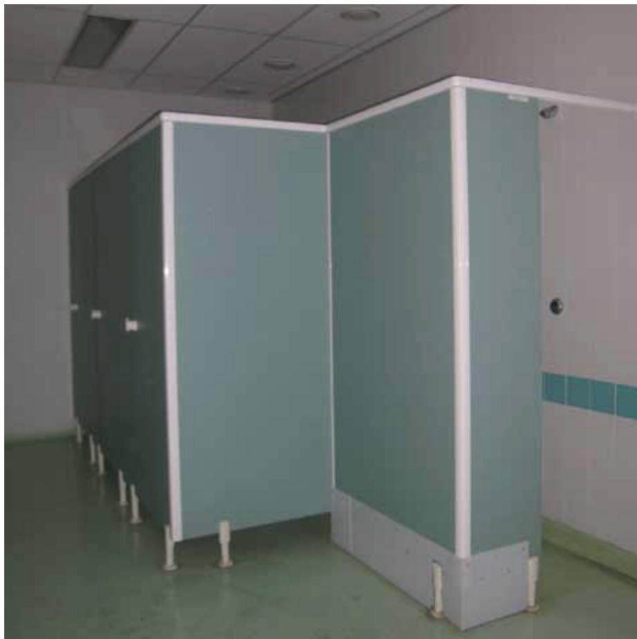
Afbeelding 67. De douchecabines (1997) in ruimte E0.03. De douchecabines vervangen de uit 1981 daterende voorgangers, die hier bij het inbouwen van het badhuis werden aangebracht.
