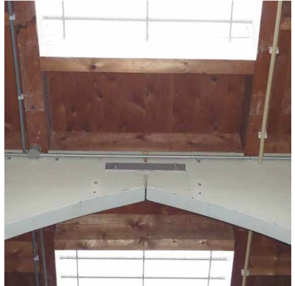
Afbeelding 114. Detail van de vorige afbeelding met de verbindingstrips tussen beide spantbenen. De afdrukken met schroefgaten behoren bij de voormalige ringen en andere gymnastiekattributen in deze zaal.
