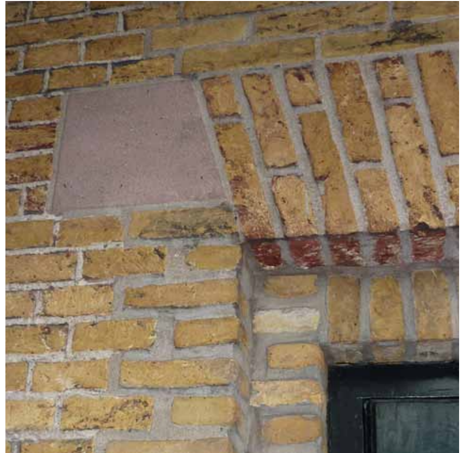
Afbeelding 33. Detail van de strek met aanzetsteen boven de deur. Aan de onderzijde van de strek zijn op de bakstenen duidelijk resten van de rode verflaag aanwezig, waarvan de strekken en speklagen waren voorzien.
