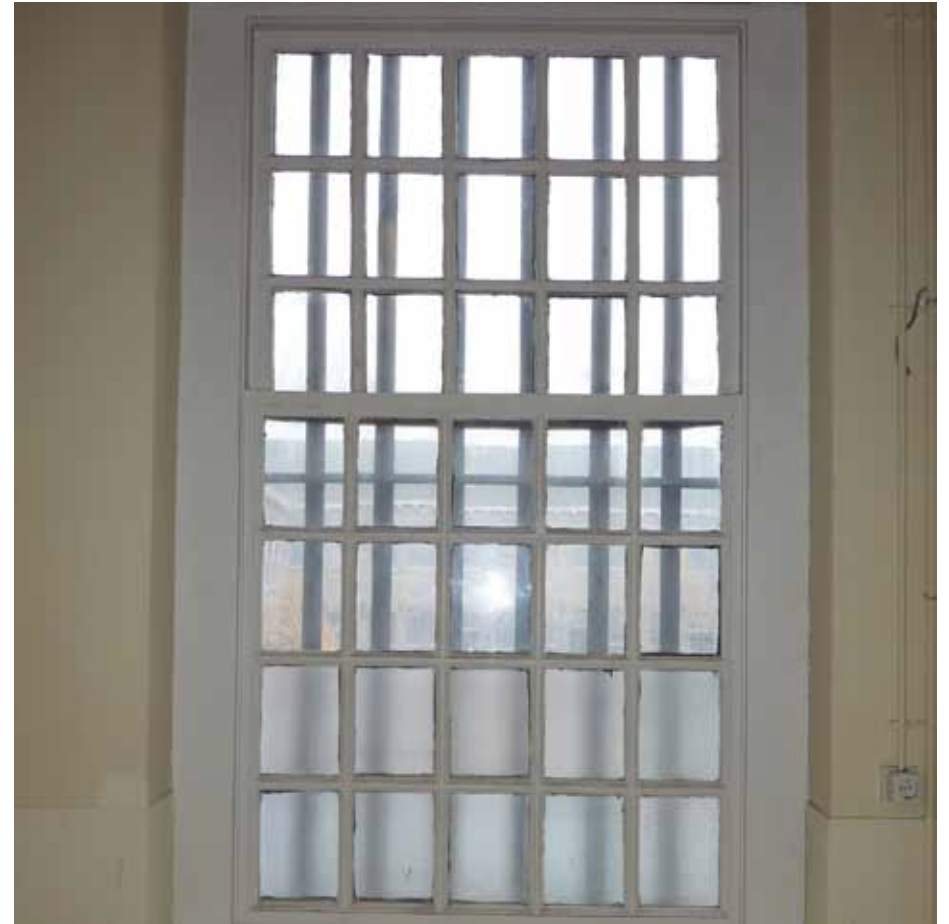
Afbeelding 101. Detail van één van de schuiframen. De schuiframen zouden mogelijk kunnen dateren uit de bouwtijd van de vleugel (1822), of zijn ouder en van elders hergebruikt.
