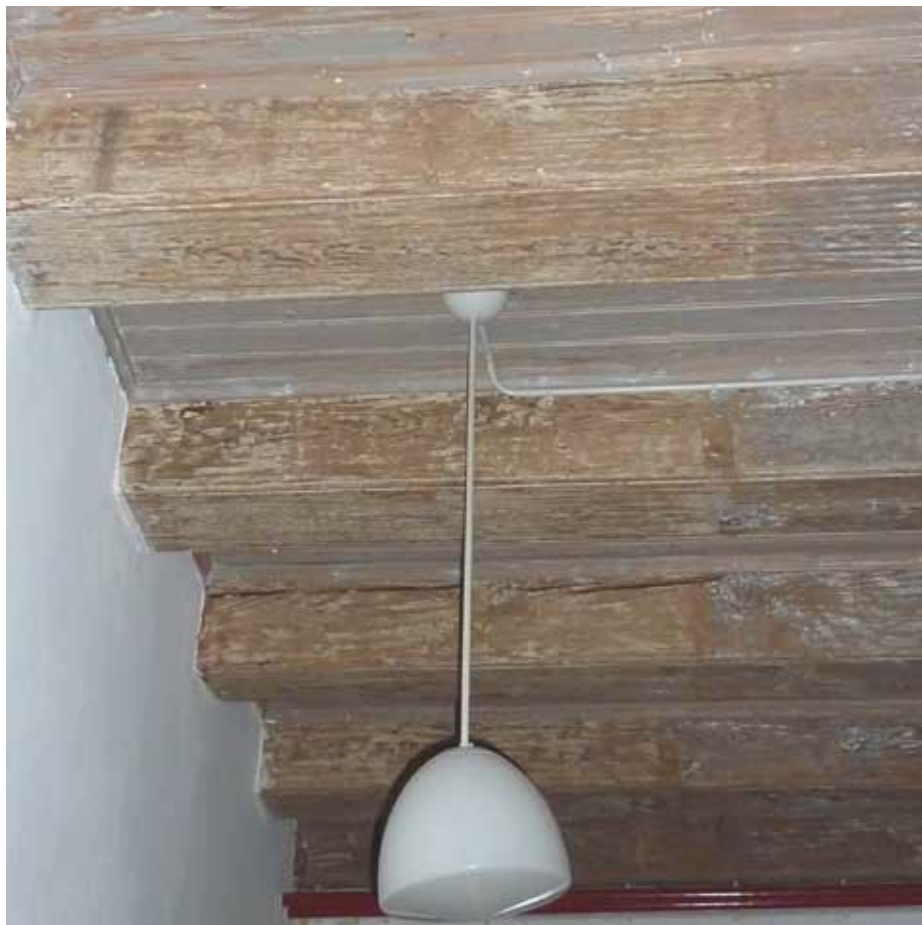
Afbeelding 45. Balklaag in het linker gedeelte van ruimte F0.02, gezien richting het noordwesten. Op de balken tekenen zich sporen van een gangwand af.
