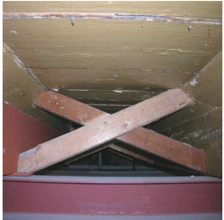
Afbeelding 53. Zicht tussen de balken in ruimte F0.17. Vanwege de hart op hart afstand van één meter zijn tegen het doorbuigen van de vloerdelen in 1959 onder 45 graden afgeschuinde regels aangebracht. Bij het verstevigen van de balklaag zijn ongeschaafd vurenhouten andreaskruizen aangebracht tussen de balken. Deze zijn opmerkelijk zorgvuldig ingelaten in de kantplanken. Geheel onder is de stalen onderslagbalk (vermoedelijk 1988) zichtbaar.
