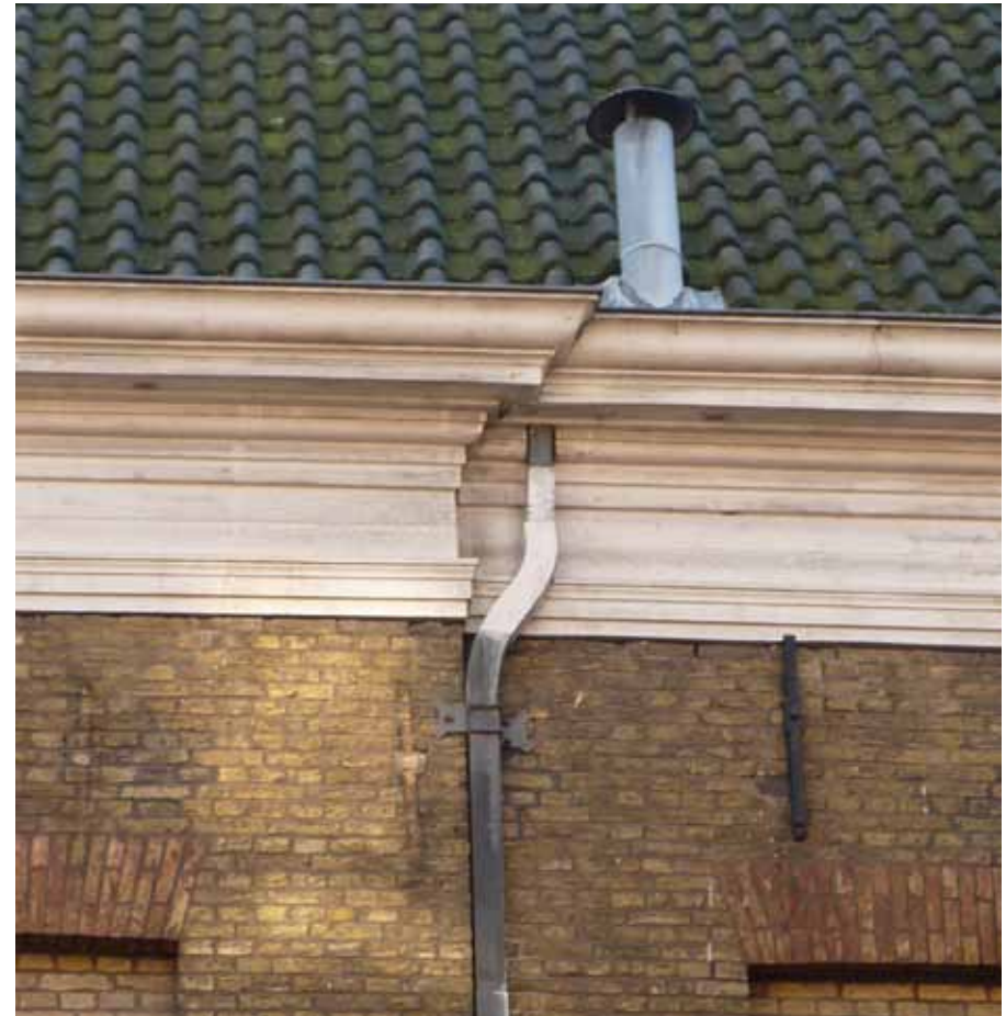
Afbeelding 11. Linker deel van de voorgevel ter hoogte van de kroonlijst. De strekse bogen boven de blindnissen zijn rood geschilderd. Hierboven tekenen zich de sporen af van de muurankers van de voormalige houten zoldervloer. Deze is in 1959 vervangen door een betonvloer. Bij het vervangen van de kap in 1959, zijn tevens romaanse pannen aangebracht.
