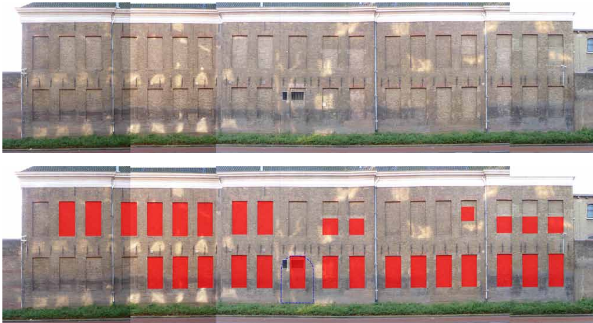
Afbeelding 121. Overzicht van de voorgevel van Bouwdeel A met daarin de dichtzettingen van de verschillende vensters sinds 1959. In het midden is de locatie van de voormalige poort gestippeld weergegeven. Deze gevelopeningen kunnen afhankelijk van de herbestemming desgewenst heropend worden. De oorspronkelijke blindnissen vertegenwoordigen een positieve monumentwaarde, zodat behoud ervan wenselijk is.
