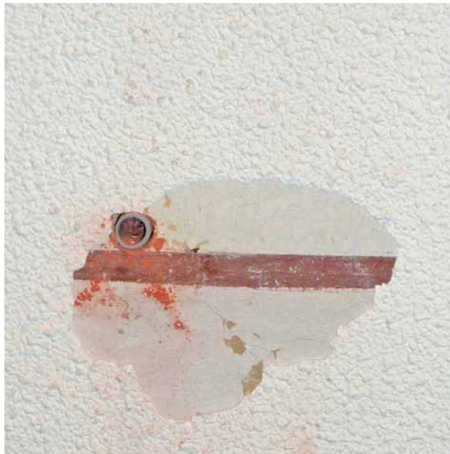
Afbeelding 35. Detail van de geschilderde rode bies op 112 cm hoogte als beëindiging van een geschilderd lambris.
