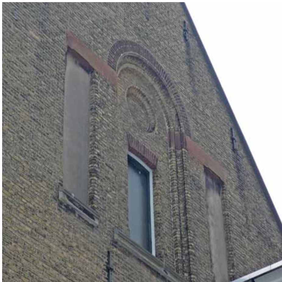
Afbeelding 20. Overzicht van de rechter zijgevel van bouwdeel B. Het metselwerk, verlevendigd met zandstenen blokken uit Udelfanger zandsteen en rode rondbogen en profielstenen, werd zeer zorgvuldig uitgevoerd.
