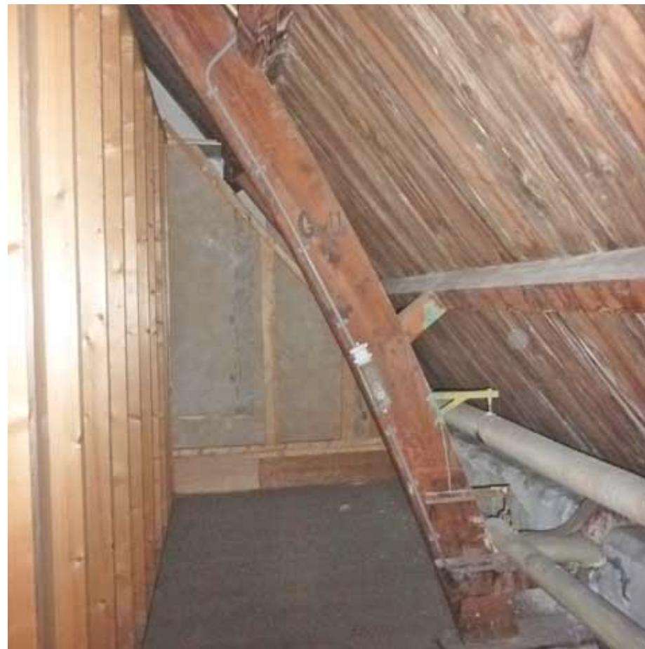
Afbeelding 82. Zicht in één van de loze ruimten tussen de borstwering en de voorzetwanden.
