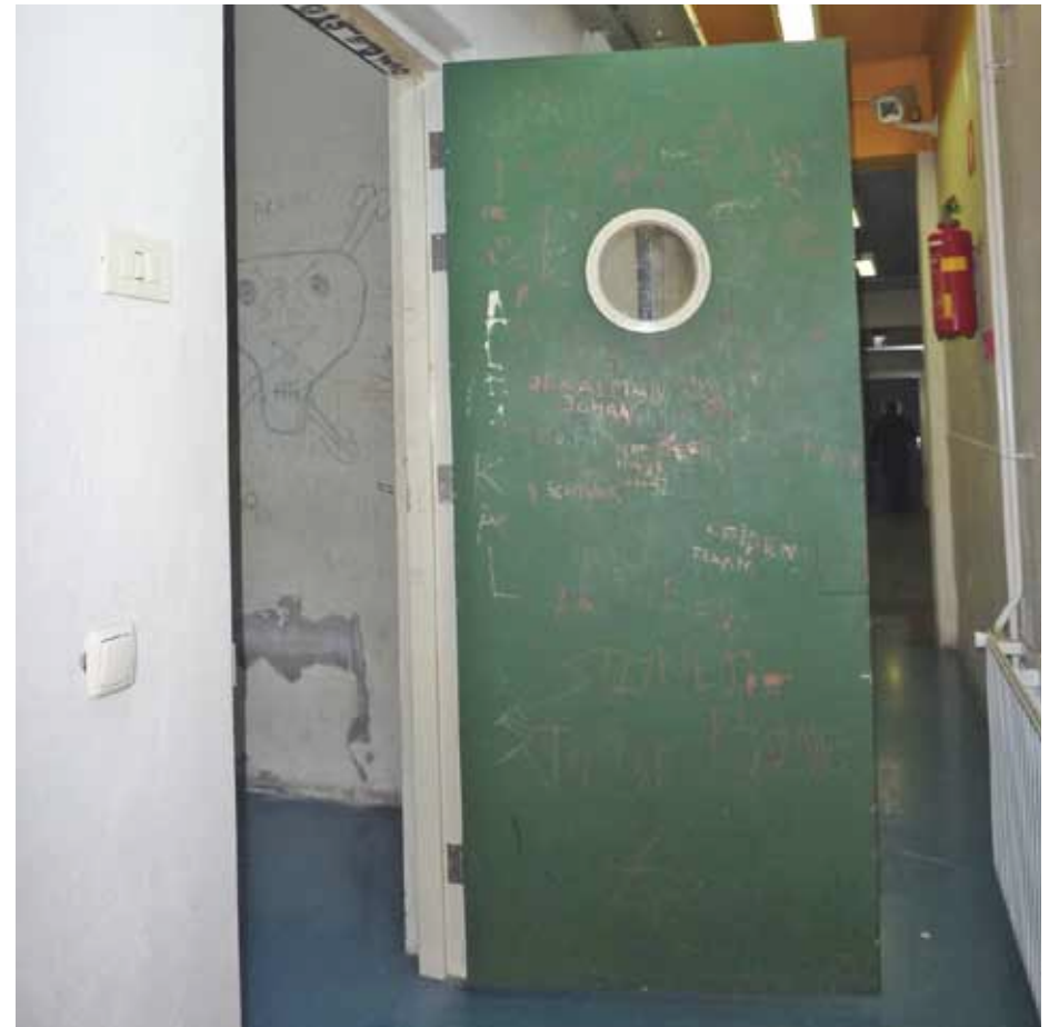
Afbeelding 39. Overzicht van ruimte M0.04 gezien richting het noorden met de celdeur van M0.05 (1988).
