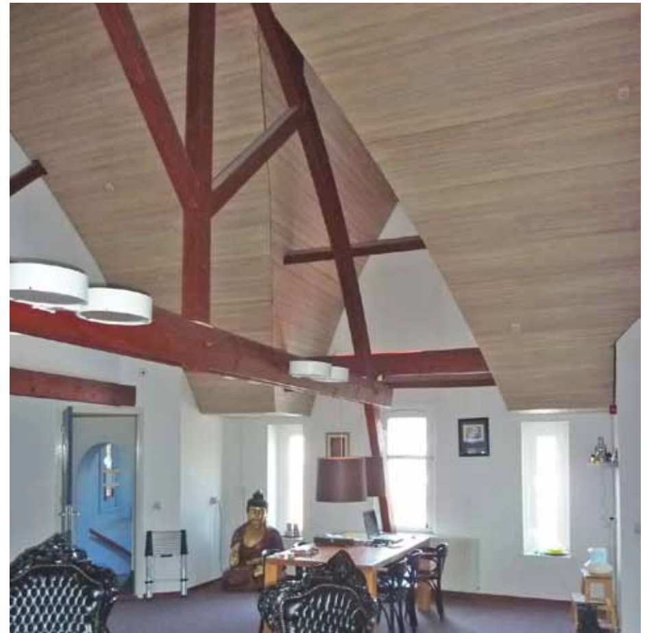
Afbeelding 77. Overzicht van ruimte M2.04 gezien richting het westen. Het tongwelf dateert van de verbouwing van 1988.
