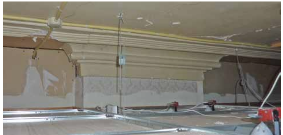
Afbeelding 90. Details van enkele stucplafonds uit de bouwtijd (1870). Deze plafonds vormen tezamen met een klein deel van de binnenmuren nog de laatste interieuronderdelen met een hoge monumentwaarde. De stucplafonds maken een herstel van de oorspronkelijke indeling met schouwen en kastenwanden nog mogelijk, waardoor het interieur sterk aan ruimtelijke kwaliteit kan winnen.
