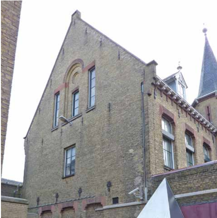
Afbeelding 18. Zicht op de linker zijgevel. De vensterindeling met gekoppeld venster op de tweede verdieping met blindnis dateert uit de bouwtijd van het bouwdeel (1870).
