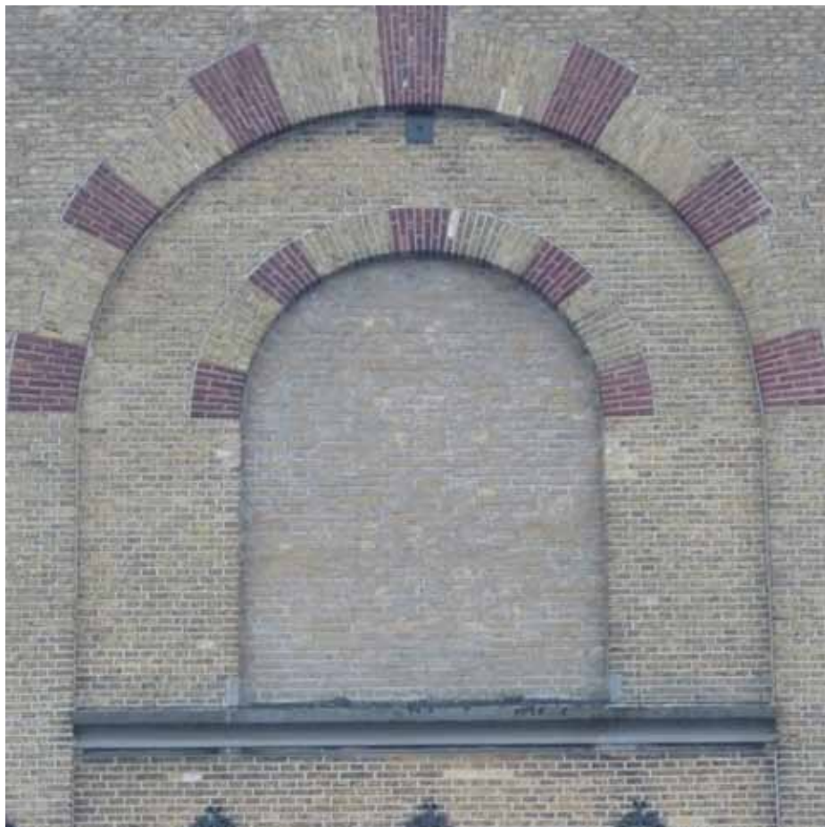
Afbeelding 12. Zicht op één van de dichtgezette vensters in de noordgevel van bouwdeel C. Het venster werd vermoedelijk dichtgezet tijdens het inbrengen van de sportzaal in 1988-1991.
