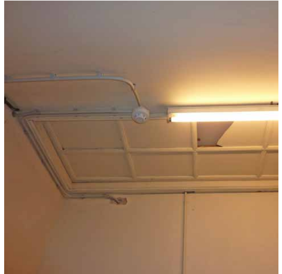
Afbeelding 85. Zicht op de linker helft van het daklicht in ruimte K3.06. Het plafond is voorzien van acht-ruits roedenramen als plafondlichten, die de ruimten van daglicht voorzagen (1946-1947).
