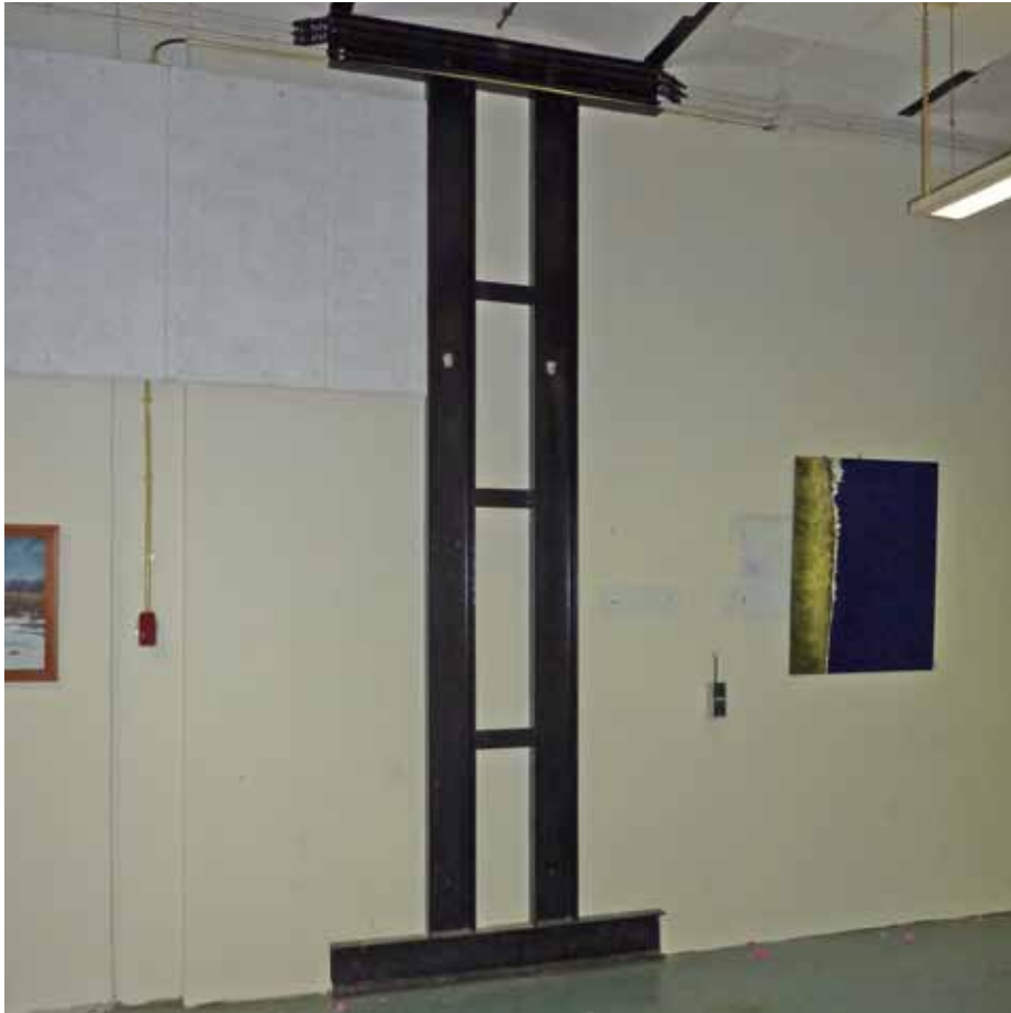
Afbeelding 60. Zicht op de staalconstructie ter plaatse van de zuidwand van ruimte K1.25, ter ondersteuning van de vloer van de bovenliggende gymzaal. Links is een sparring ten behoeve van een voormalig ventilatiekanaal zichtbaar.
