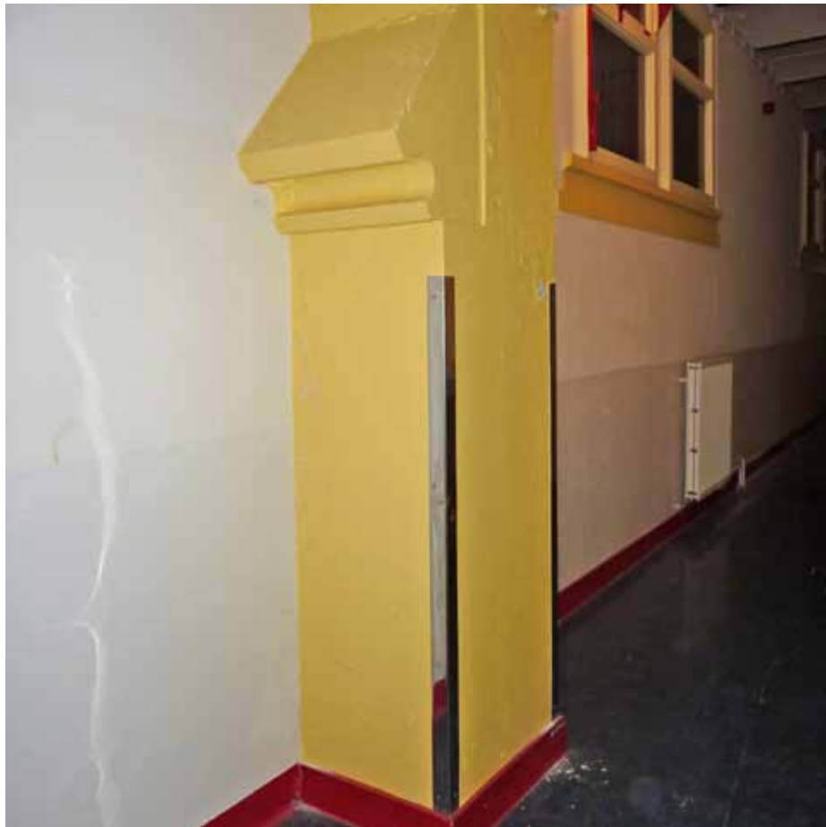
Afbeelding 63. Zicht op de muurdam ter plaatse van de doorbraak in de oostgevel van bouwdeel C ten behoeve van het realiseren van de gang K1.29 op de eerste verdieping.
