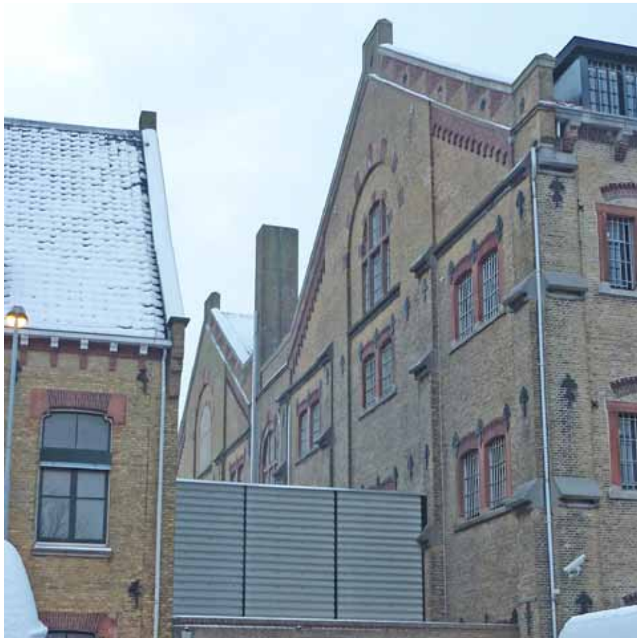
Afbeelding 103. Overzicht van de huidige situatie van de noordgevel nabij de aansluiting met bouwdeel K en B. De keuze voor het gebruik van zowel contrasterende als elementaire materialen - zoals hier het gebruik van stalen damwandprofielen - leidde in 1988 automatisch tot een weinig harmonieus eindresultaat en een aantasting van de architectuur van dit 19de-eeuwse bouwdeel. Verwijdering of aangepaste vervanging is wenselijk.
