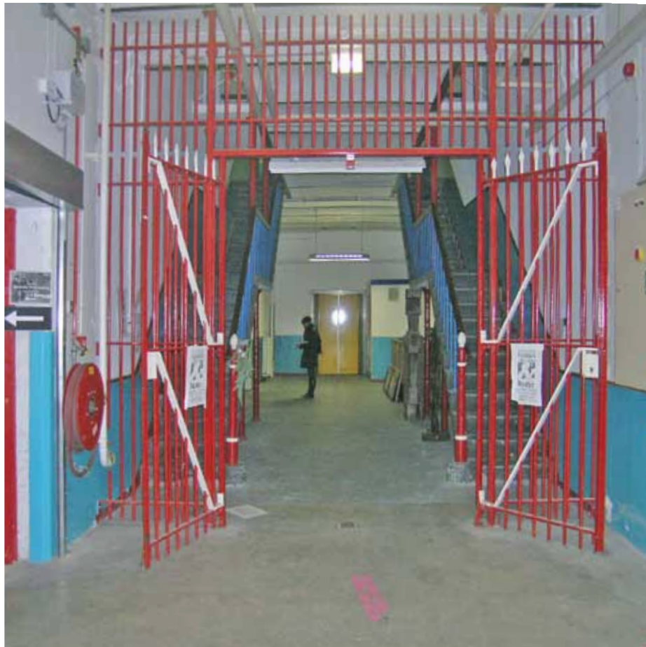
Afbeelding 107. Zicht in het trappenhuis op de begane grond met aan het eind de liftdeur. Door de bouw van de liftschacht is de daglichttoetreding van het trappenhuis nagenoeg verdwenen.
