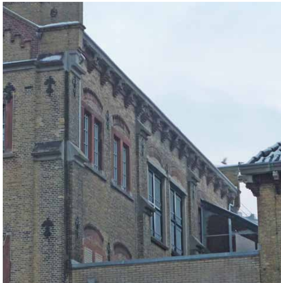
Afbeelding 5. Overzicht van het bovenste gedeelte van de oostgevel van bouwdeel C. De middelste ramen van de tweede verdieping werden bij het inrichten van de achterliggende ruimten tot sportzaal vergroot (1988-1991).
