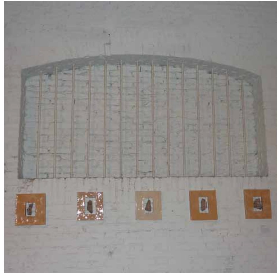
Afbeelding 112. Detail van één van de ramen in de bouwmuur van ruimte K0.09 met het nog behouden traliewerk. De openingen waren oorspronkelijk uitsluitend van tralies voorzien. Indien de dichtzettingen in de bouwmuren weer heropend zouden worden, kunnen deze tralies als voorbeeld dienen.
