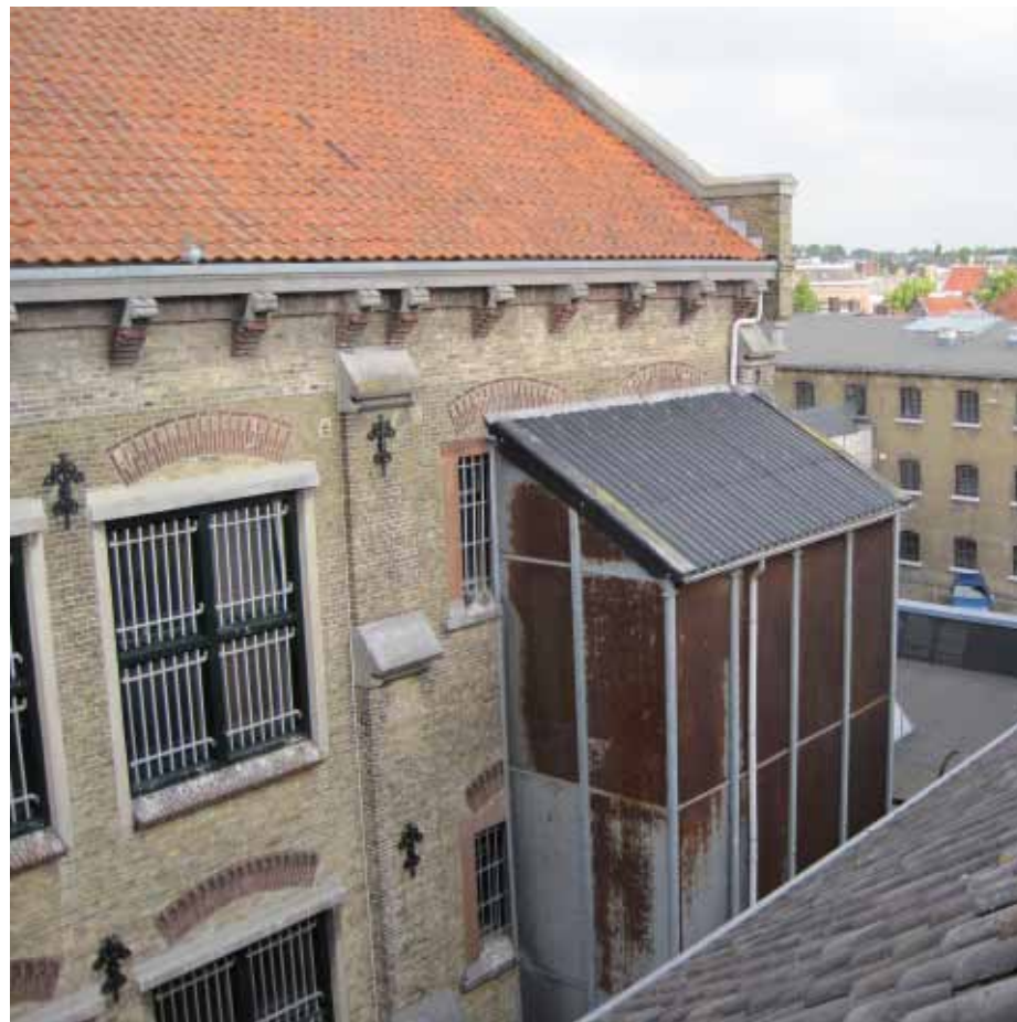
Afbeelding 7. Zicht op het rechter gedeelte van de oostgevel ter hoogte van de eerste en tweede verdieping. De linker ramen werden bij het inrichten van de achterliggende ruimten tot sportzaal vergroot (1988-1991). Het roestende stalen noodtrappenhuis rechts dateert uit dezelfde bouwperiode.
