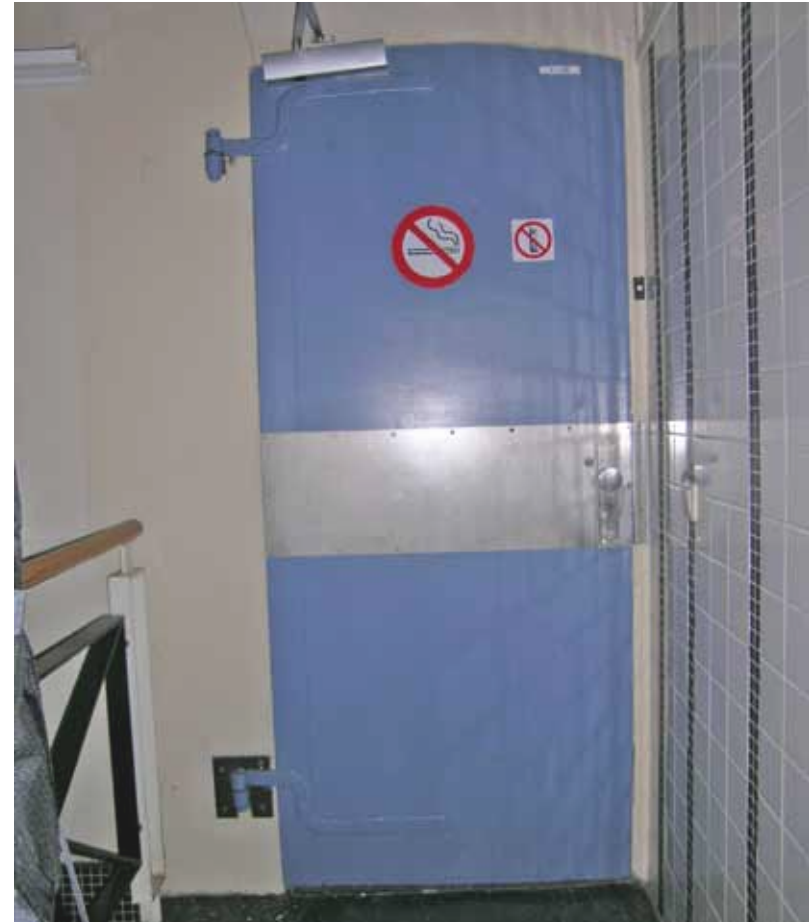
Afbeelding 43. Detail van de voorgaande afbeelding met de deur naar het trappenhuis K1.06. De deur stamt uit de bouwtijd (1870).
