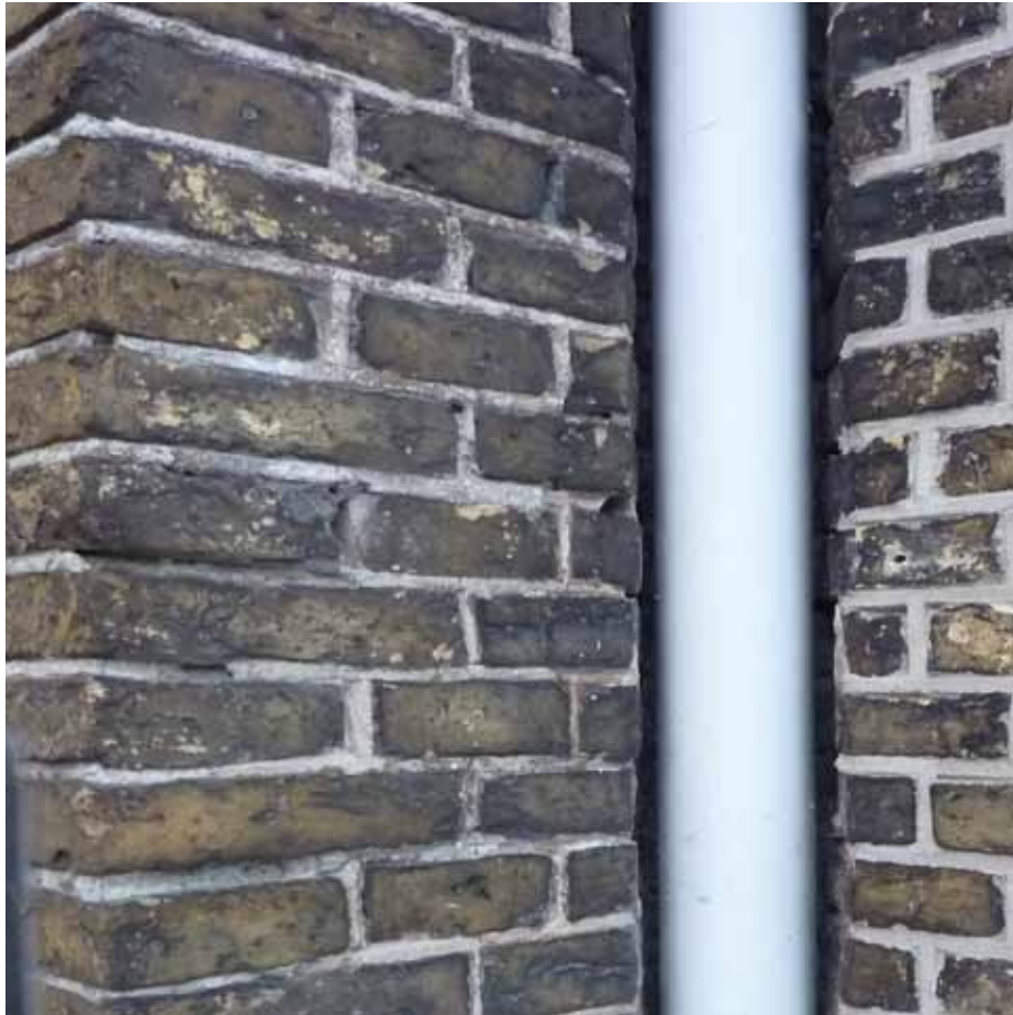
Afbeelding 105. Detail van de noordwestelijke hoek van het gebouw met de pvc hemelwaterafvoer. De oorspronkelijke hemelwaterafvoeren bestonden uit gietijzeren buizen van 8 cm doorsnede met een wanddikte van 5 mm en zouden wederom aangebracht kunnen worden. Rechts is een zone met - te hard - vervangen voegwerk zichtbaar, dat tot vorstschade aan het baksteenwerk heeft geleid.
