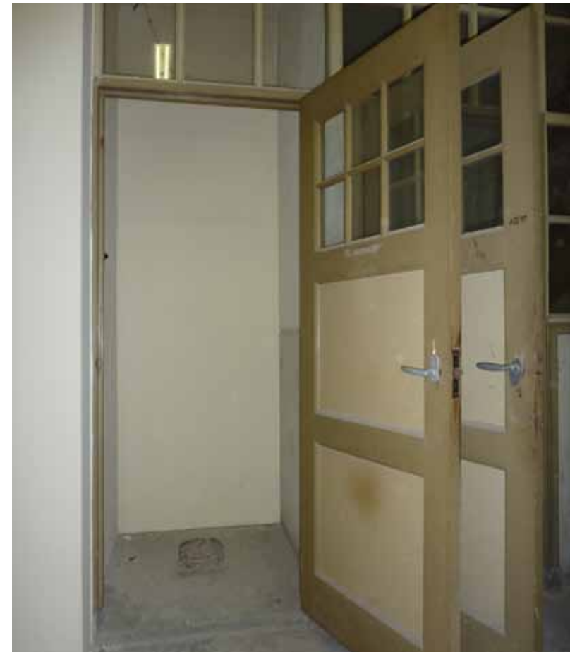
Afbeelding 90. Zicht in toilet K3.08 gezien richting het oosten. De toiletruimte dateert uit 1946-1947 en werd vermoedelijk tijdens of na de verbouwing van 1988-1991 ontmanteld. De deuren zijn voorzien van hang- en sluitwerk uit de jaren '40 van de 20ste eeuw.
