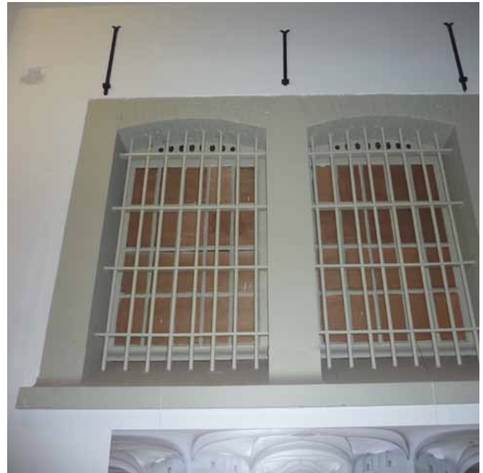
Afbeelding 118. Detail van één van de ramen in de noordgevel van het alkovengebouw, gezien vanuit de gang K0.06. De ramen - thans dichtgezet - zijn hier nog voorzien van de originele uit de bouwtijd daterende ijzeren ramen met 20-ruits roedenverdeling (1870). Deze ramen kunnen derhalve als model dienen, indien de huidige houten exemplaren vervangen zouden worden (Afbeelding 114). Markant zijn de ventilatie voorzieningen aan de bovenzijde. De gevel was vermoedelijk ongepleisterd, zodat de rode bakstenen segmentbogen beter tot hun recht kwamen. Linksboven is nog een zinken ventilatierooster behouden (1870).
