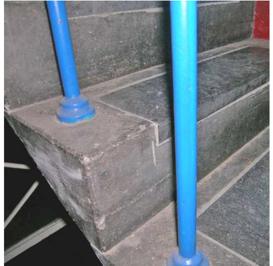
Afbeelding 23. Detail van één van de trappen. De sterk uitgesleten treden op de begane grond werden tijdens één van de laatste verbouwingen voorzien van nieuwe ingelijmde stroken hardsteen (1997).
