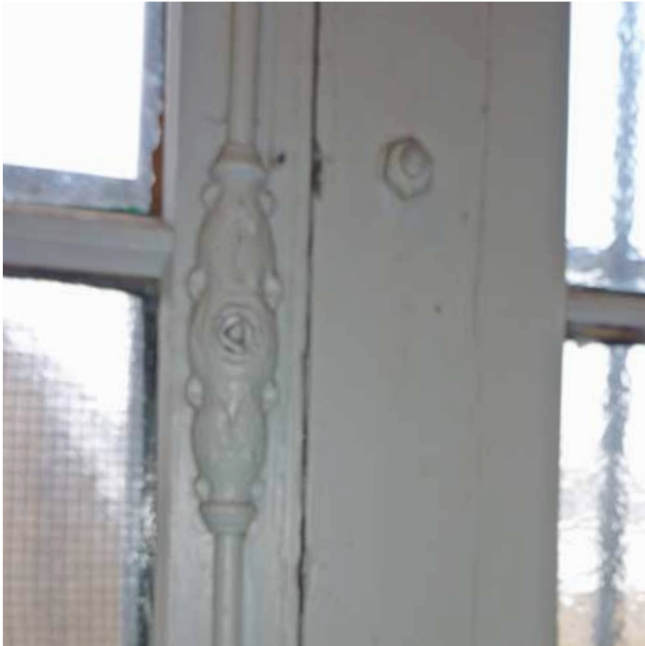
Afbeelding 121. Detail van het oorspronkelijke hang- en sluitwerk van de ramen op de derde verdieping. De knop van de espanjolet is hier verdwenen. Bij werkzaamheden aan de ramen zou dit hang- en sluitwerk als uitgangspunt genomen kunnen worden.
