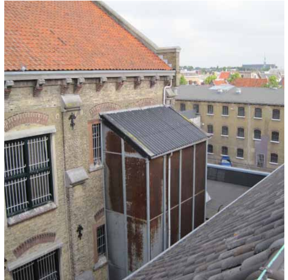
Afbeelding 102. Zicht op het vluchttrappenhuis van de sportzaal tegen de oostgevel. Het roestende trappenhuis tast de kwaliteit van deze gevel sterk aan.
