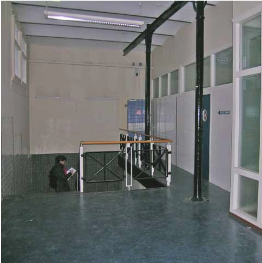
Afbeelding 42. Overzicht van ruimte K1.01 gezien richting het oosten met de trap naar de begane grond. Rechts is de lichte scheidingswand met een tweetal bezoekkamers zichtbaar (1997).
