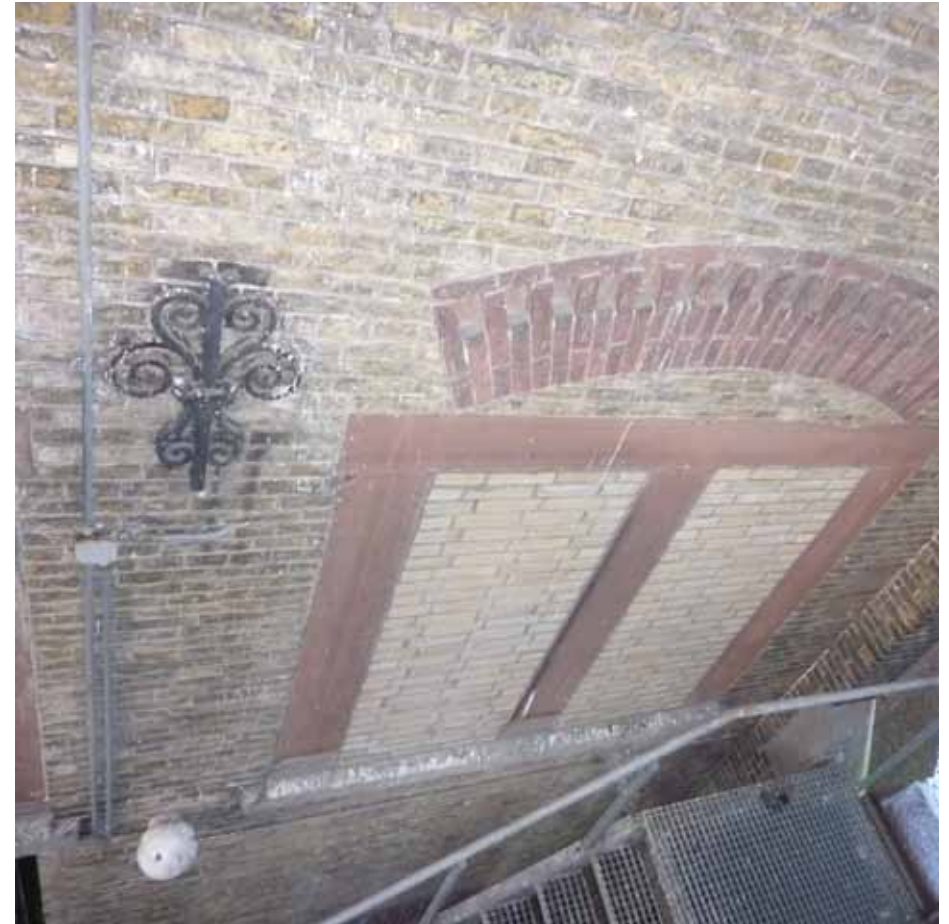
Afbeelding 106. Detail van één van de gedichte vensters in de oostgevel. Deze vensters zouden weer heropend kunnen worden. De vluchttrap en bijbehorende recente doorgangen in het muurwerk, zoals juist linksonder in de foto zichtbaar, kunnen daarbij verwijderd respectievelijk gedicht worden.
