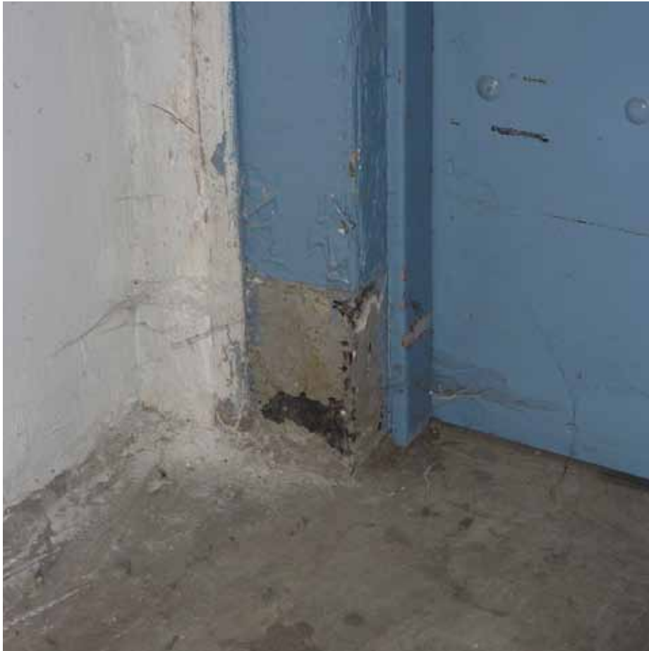
Afbeelding 25. Detail van de onderzijde van de linker stijl van de deur van de voorgaande afbeelding. De gecementeerde neuten wijzen op aanpassingen van dit kozijn in de jaren 1946-1948.
