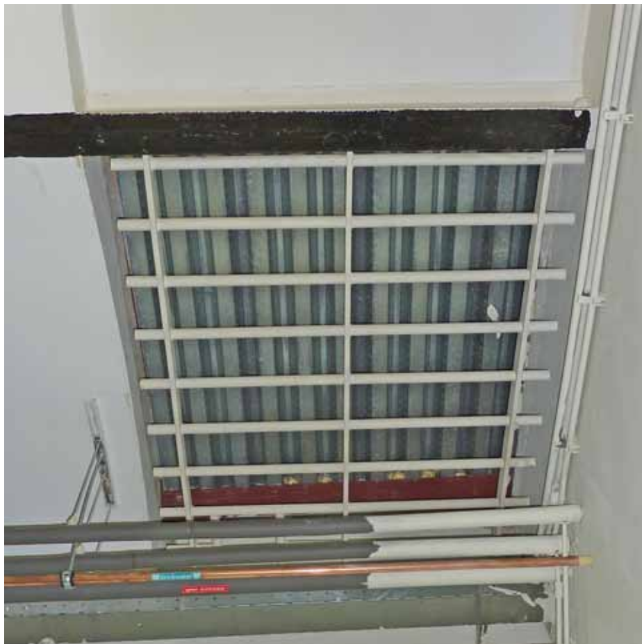
Afbeelding 73. Zicht op het voormalige plafond in ruimte K2.17. Het plafondlicht werd ten tijde van de renovatie van de gangen en bouw van de lift in 1997 door de bovenliggende zwalustaart betonvloer gedicht.
