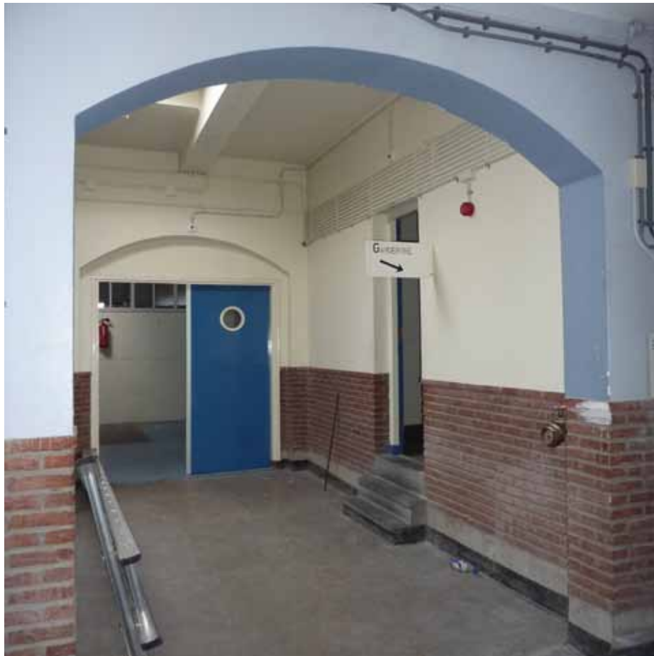
Afbeelding 94. Overzicht van ruimte K3.14 gezien richting het westen. De getoogde doorgangen zonder deuren, alsmede de gemetselde lambrisering behoren tot de bouwphase van 1946-1947. De blauwe deuren met patrijspootjes dateren van de verbouwing uit de jaren 1988-1991. Geheel links achteraan, juist voor het laatste portaal, bevond zich de trap naar het dakterras van de aan de zuidzijde gelegen ziekenluchtplaats.
