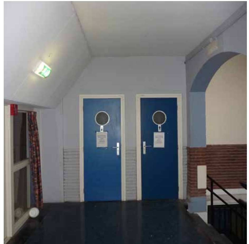
Afbeelding 91. Overzicht van ruimte K3.14, gezien richting het zuiden. De ruimte kwam in 1946-1947 tot stand, op het moment dat de derde verdieping - De zolderverdieping - ingericht werd met leslokalen en een bibliotheek. De gemetselde labrisering behoort bij deze bouwphase. De toiletdeuren werden vervangen in 1988-1991, tegelijkertijd met het inbouwen van de pui van de sportzaal links en het afwerken van de vloer met marmoleum.
