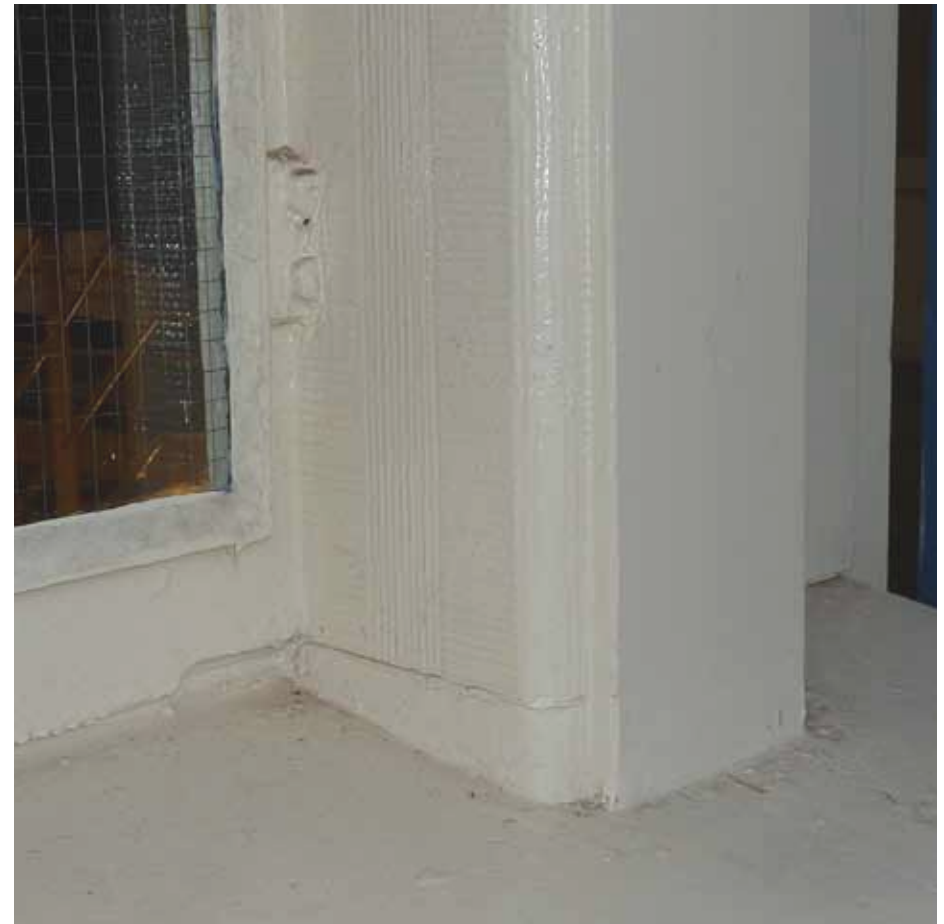
Afbeelding 52. Detail van de onderzijde van het twee bouwlagen hoge venster in de noordelijke kopgevel. De hardstenen stijlen (1891) zijn gefrijnd en sluiten middels een loodstrook aan op de hardstenen onderdorpel. De stalen ramen werden voorzien van draadglas (1988).
