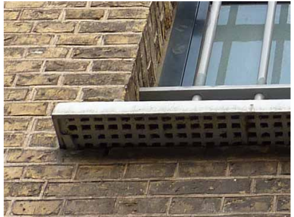
Afbeelding 15. Detail van de onderzijde van één van de standaard onderdorpels. De onderdorpel is hol en aan de onderzijde voorzien van openingen ten behoeve van de ventilatie van de achterliggende cellen (zie detailtekening Afbeelding 104). Onregelmatig metselwerk aan weerszijden van de onderdorpel geeft aan dat deze vensters later werden verlengd (1948).
