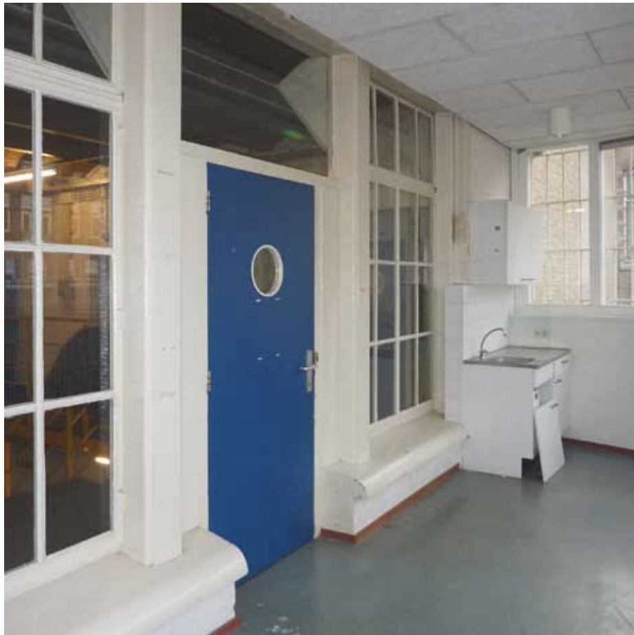
Afbeelding 51. Overzicht van ruimte A1.26 gezien richting het westen. Ten behoeve van de toegang tot de bewakersruimte werd de borstwering onder het middelste deel van het grote venster in de noordelijke kopgevel doorgebroken. Hierbij werden tevens de stalen vensters vervangen voor een 'patrijspoortdeur'. Links en rechts van de deur bleef het venster behouden, inclusief onderdorpel.
