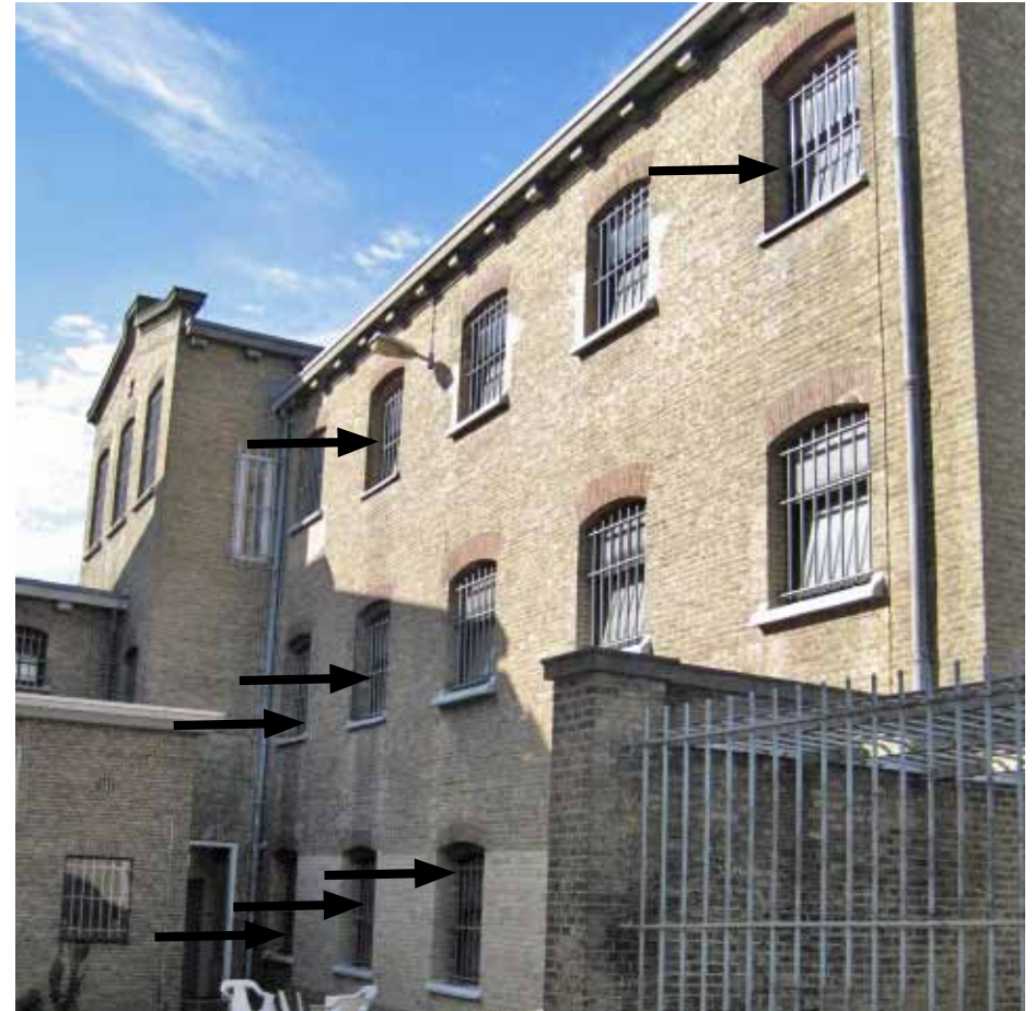
Afbeelding 7. Overzicht van het rechter gedeelte van de oostgevel. De zijgevel is ter hoogte van anderhalve meter boven het trasraam recent (1997) ingeboet met een lichtere steen. De met pijlen aangegeven vensters zijn uitgevoerd met afwijkend uitgevoerde segmentbogen (zie ook Afbeelding 14). Foto: Dhr. Bastiaans, Monumentenwacht Overijssel en Flevoland / Drenthe 2009.
