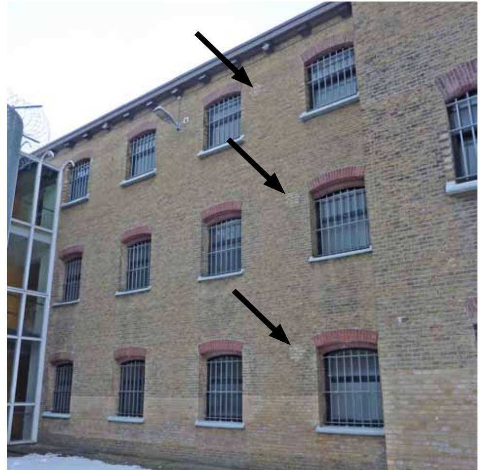
Afbeelding 13. Zicht op het linker gedeelte van de oostgevel. De vensters ter hoogte van de begane grond en eerste verdieping van dit gedeelte bezitten een afwijkend gedetailleerde onderdorpel en segmentboog ten opzichte van de overige vensters (zie ook Afbeelding 14). Dit geldt eveneens voor een aantal vensters in het rechter gedeelte van de noordgevel (zie Afbeelding 7 en Afbeelding 12). De drie vierkante inboetingen ter plaatse van de pijlen waren voorheen ventilatieroosters (zie Afbeelding 11).
