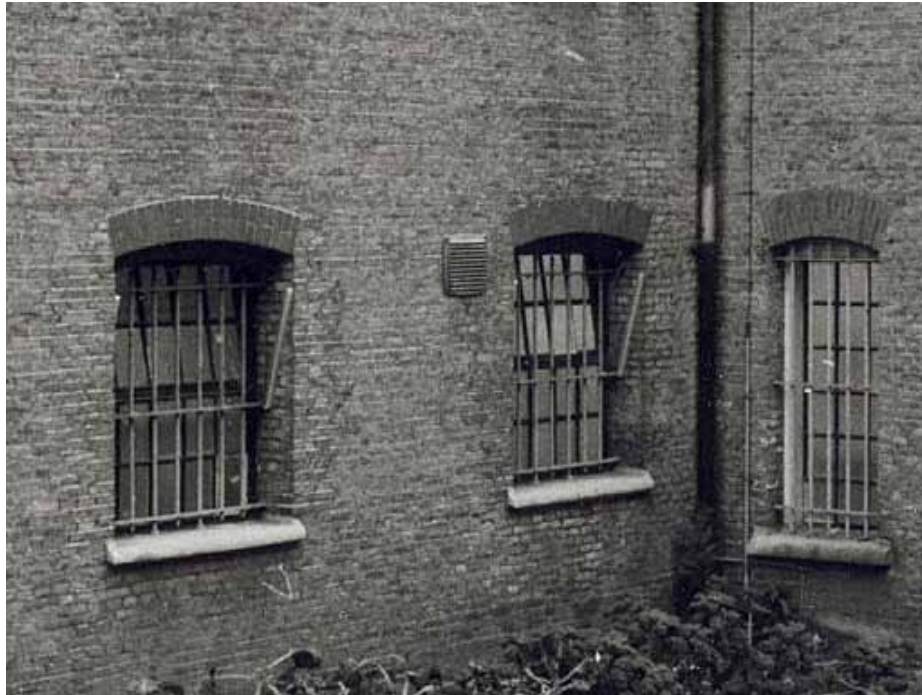
Afbeelding 16. Fragment van Afbeelding 11 van de westgevel in februari 1983). De in 1997 vervangen ijzeren vensters bestonden uit 10-ruits vaste onder- en naar binnen vallende bovenramen. In tegenstelling tot de hemelwaterafvoeren van bouwdeel I, werden de hemelwaterafvoeren van bouwdeel F niet ingekast, maar op de gevel bevestigd. Foto: Collectie Beeldbank Leeuwarden, documentnr.: FDBLHSPLB051
