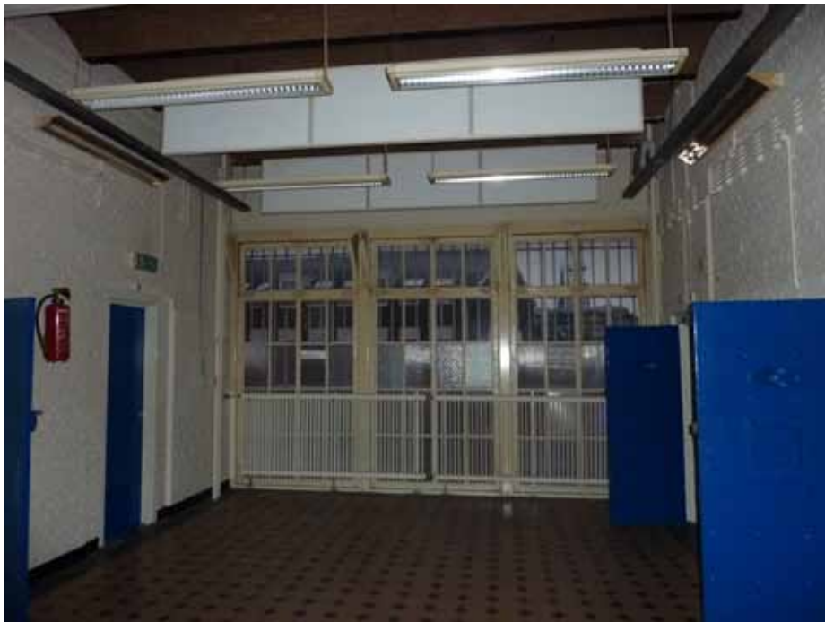
Afbeelding 35. Overzicht van ruimte A2.27 gezien richting het noorden (kopgevel). Hier bevinden zich de oorspronkelijke stalen ramen nog in het venster in de kopgevel.
