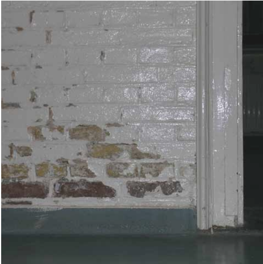
Afbeelding 19. Detail van de onderzijde van de wand van de cellenhal. De gemetselde wanden bestaan uit wit gesausde (1988) IJsselsteentjes in kruisverband met geknipte voegen. De onderste drie lagen - waarvan er twee achter de blauw geschilderde cementplint (0,8 x 7,5 cm) wegvallen – bestaan uit een afwijkende rode steen.
