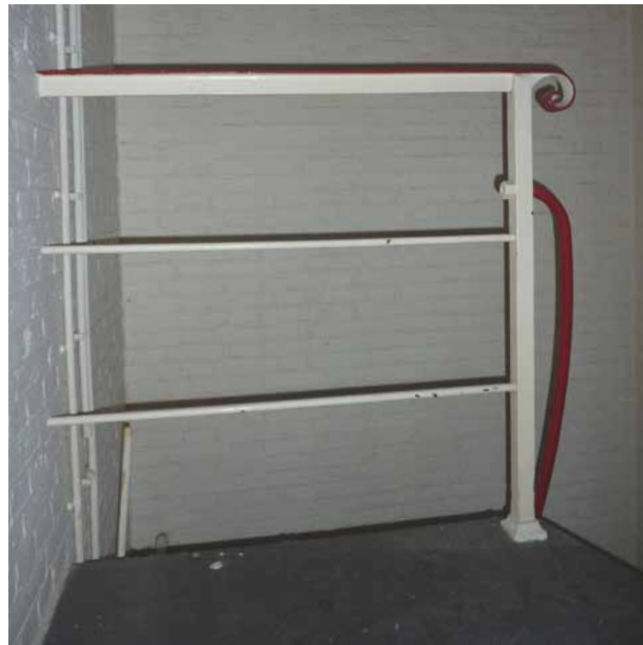
Afbeelding 63. Zicht op de balustrade ter hoogte van het bordes op de tweede verdieping. De geheel ijzeren balustrade bestaat uit twee horizontale spijlen en een T-vormige handlijst, ter plaatse van de vierkante baluster beëindigd door middel van een krul. Vermoedelijk waren de balustrades langs de galerijen in de cellenhal op dezelfde wijze gedetailleerd, voordat deze in 1988 uit veiligheidsoverwegingen werden vervangen door hogere balustrades.
