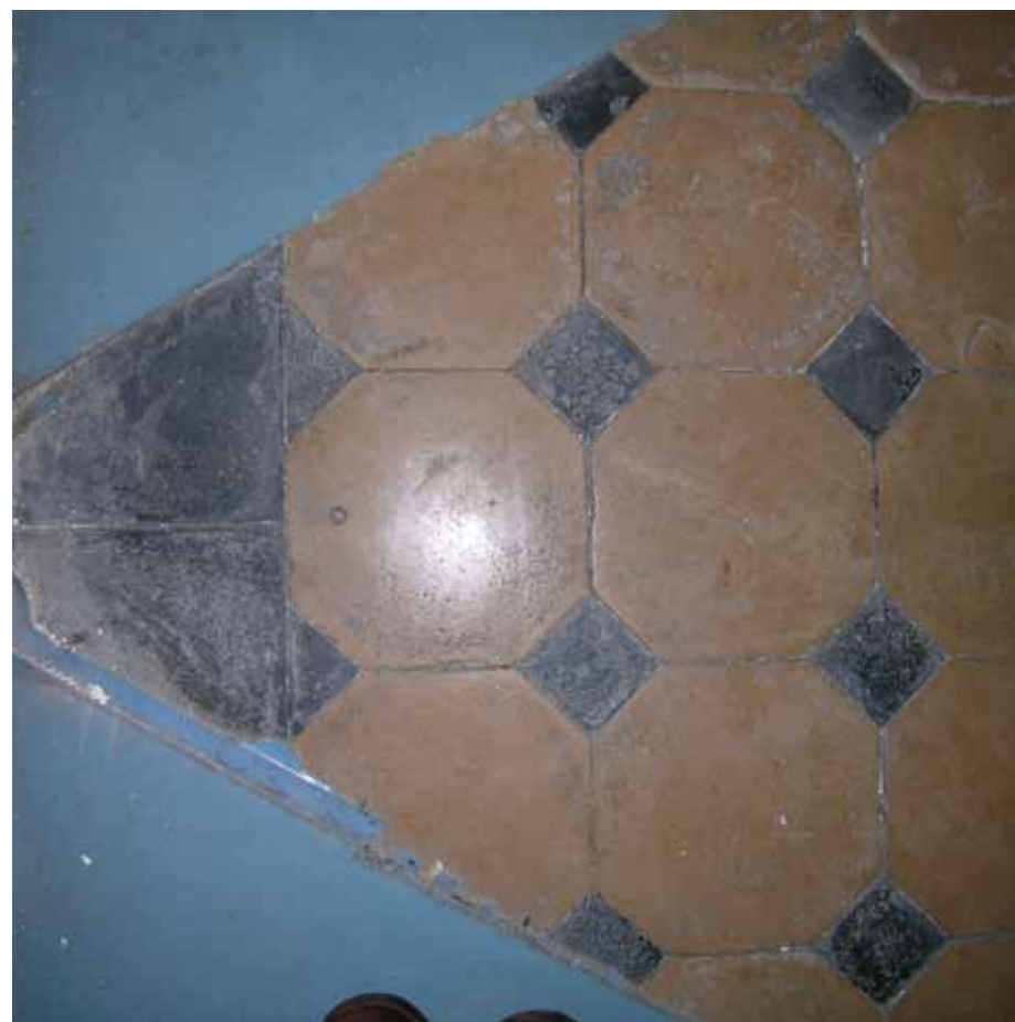
Afbeelding 89. Detail van de oorspronkelijke tegelvloer zoals deze onder de gietvloer van bouwdeel F nog aanwezig is.
