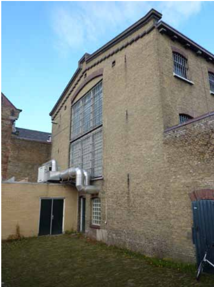
Afbeelding 8. Overzicht van de zuidelijke kopgevel. De aanbouw ter hoogte van de begane grond werd in 1997 gerealiseerd ten behoeve van de bereikbaarheid van de in bouwdeel E ondergebrachte isoleercellen.
