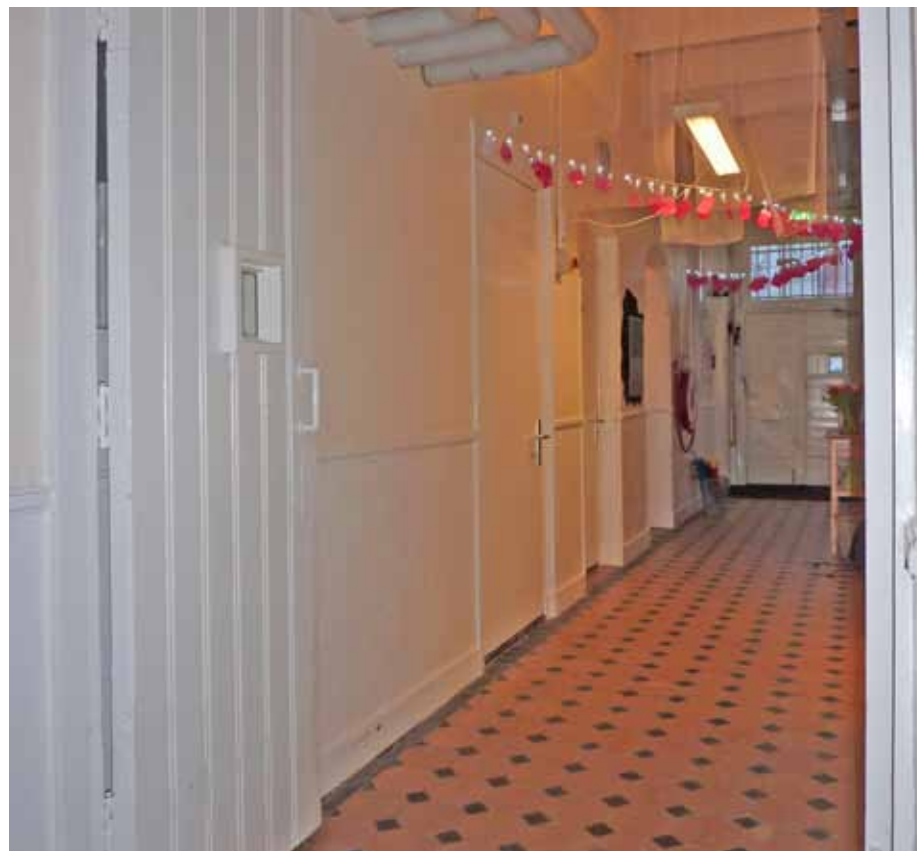
Afbeelding 14. Overzicht van de gang gezien richting het oosten. De deur links sluit de toegang tot de verbindingsgang met bouwdeel F af en is aan de zijde van de gang voorzien van een triplex beplating. De huidige lambrisingslijst werd in 1957 aangebracht, ter vervanging van de oorspronkelijke rijker geprofileerde lijst.
