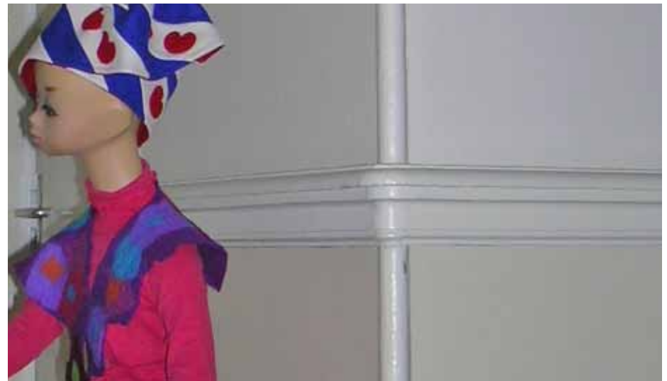
Afbeelding 23. Zicht op de hoek van de doorgang naar het tweede gedeelte van de gang ter hoogte van de eerste verdieping. Langs de wanden werden geprofileerde lambriseringslijsten aangebracht, waarbij de hoeken van de doorgangen werden voorzien van hoekbeschermers.
