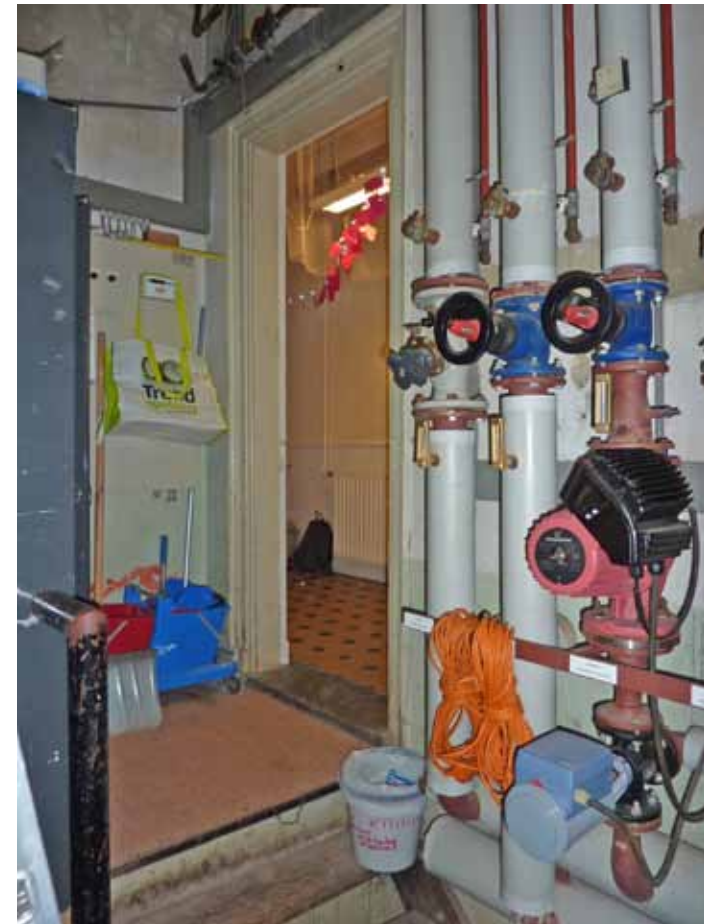
Afbeelding 36. Zicht op de doorgang naar de gang in de zuidwand. Bij het realiseren van de cv-ruimte in 1957 werd de vloer verlaagd en is via een houten trapje bereikbaar.
