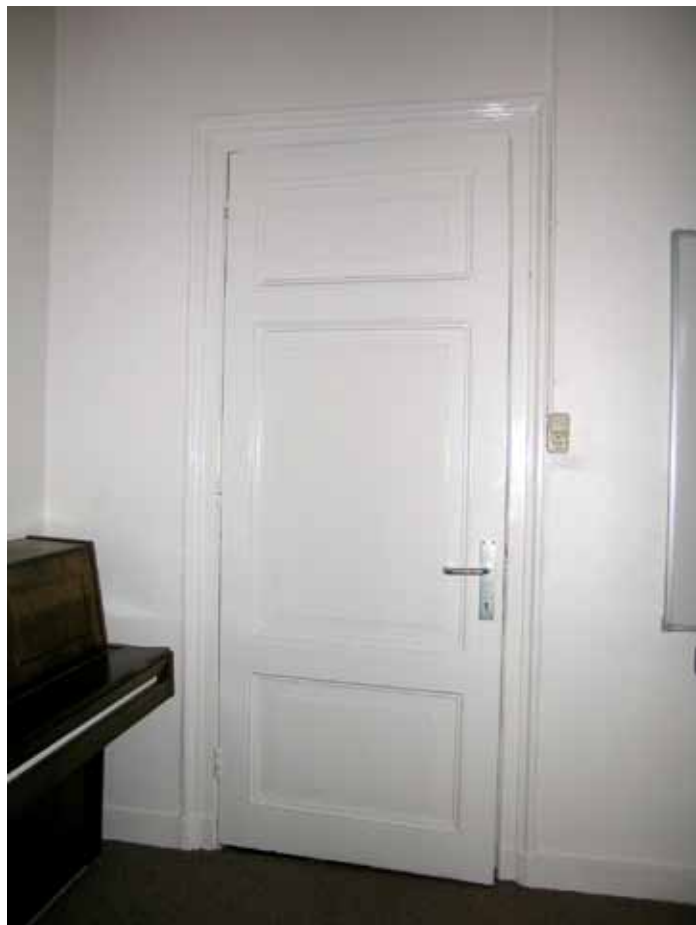
Afbeelding 68. Zicht op de binnenzijde van één van de paneeldeuren. De deur is aan de buitenzijde voorzien van een brandwerende beplating.
