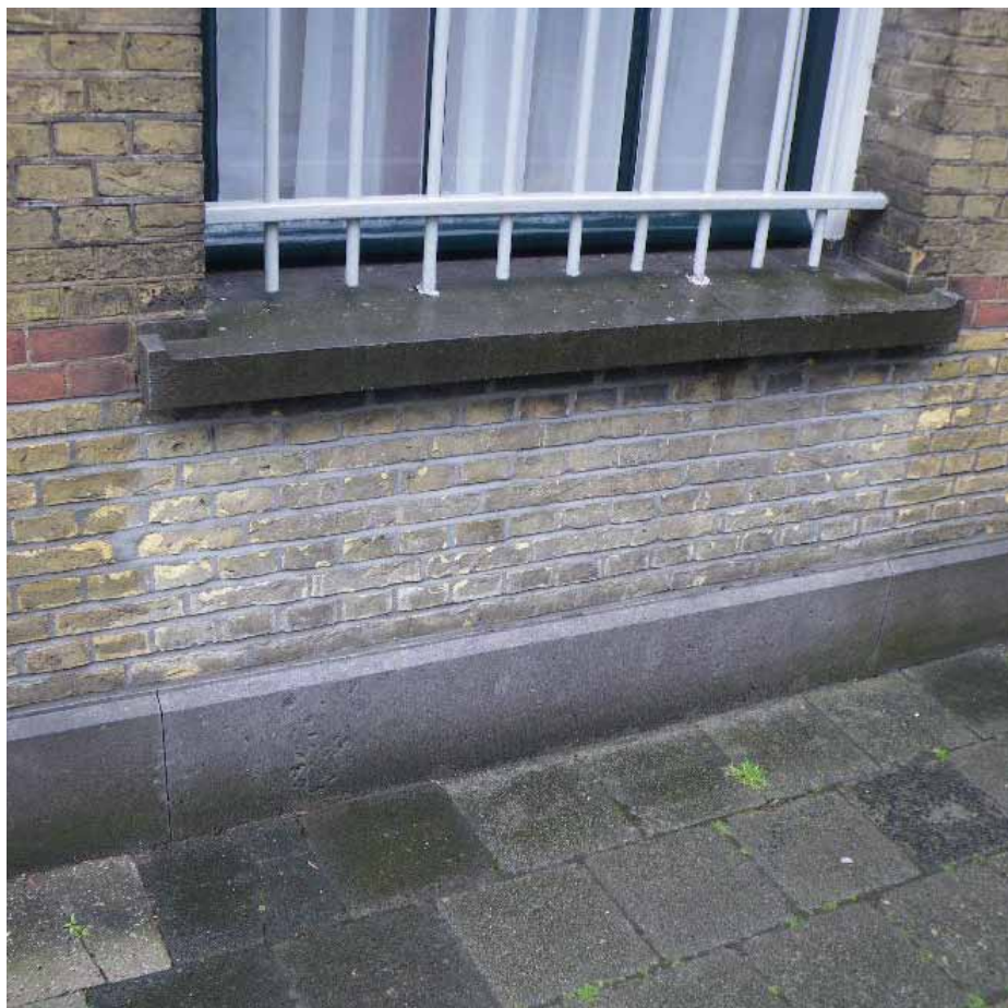
Afbeelding 7. Zicht op de borstwering onder het linker schuifvenster van de noordgevel. Mogelijk is de borstwering doorgebroken en de plint doorgezaagd ten behoeve van onderhoudswerkzaamheden of het doorvoeren van leidingen. De detaillering van het venster wijkt niet af ten opzichte van de andere vensters en de stenen zijn bij het herstelwerk hergebruikt. Foto: dhr. Bastiaans, Monumentenwacht Overijssel en Flevoland / Drenthe 2009.
