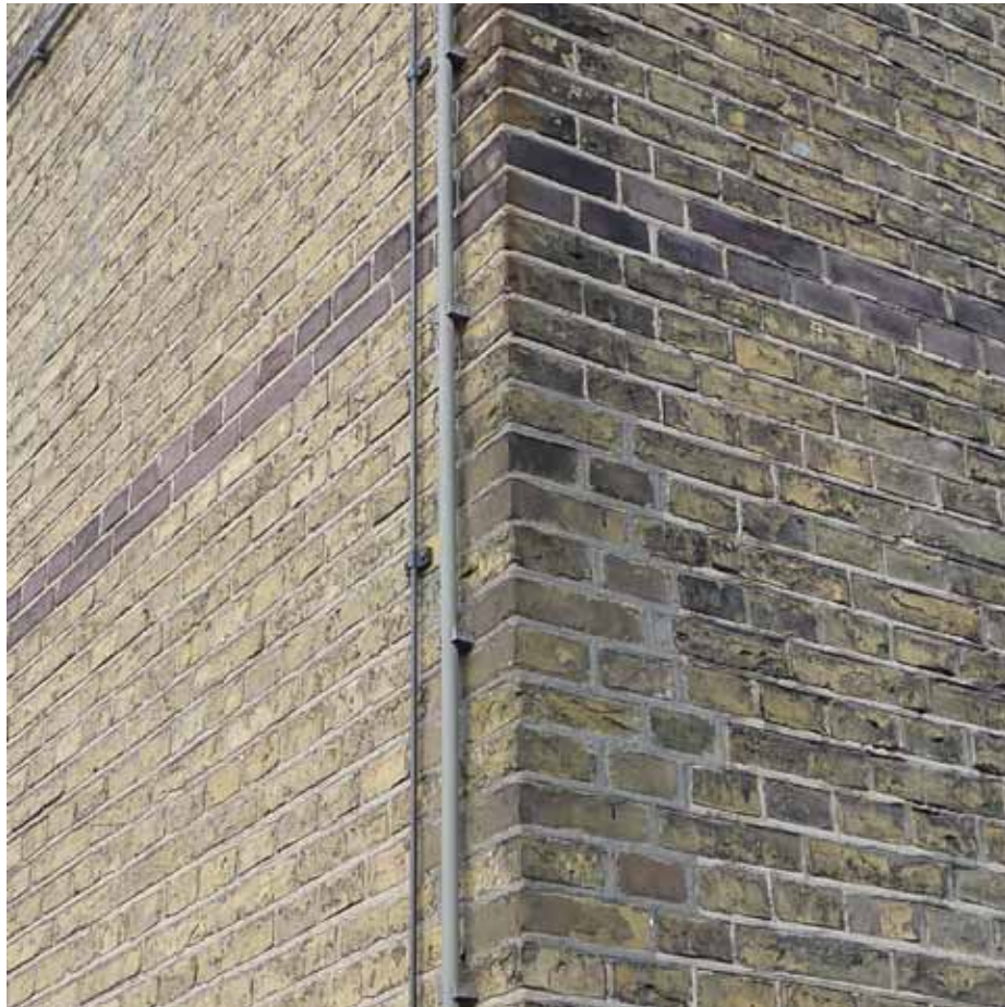
Afbeelding 9. Inboetwerk ter hoogte van de wisseldorpel van de schuifvensters van de begane grond op de hoek van de noord- en oostgevel. Waarschijnlijk bevond zich hier een hardstenen blok waar een lantaarn aan werd bevestigd (zie Afbeelding 10). Op de noordoostelijke hoek van bouwdeel G (de directiewoning) is dit hardstenen blok nog aanwezig.
