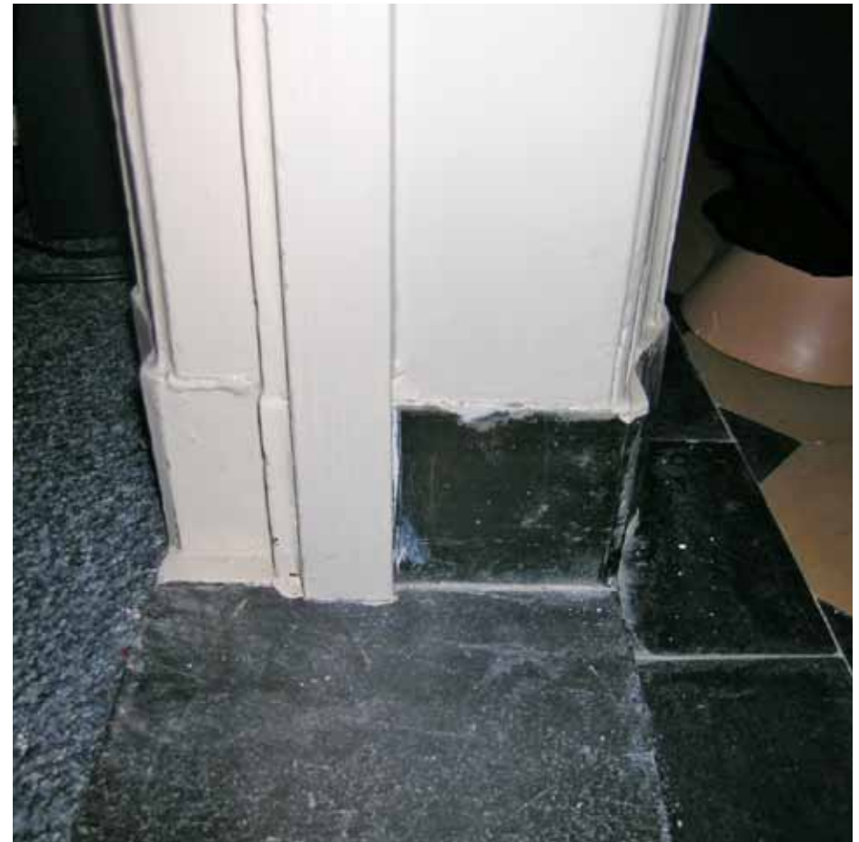
Afbeelding 47. Zicht op de onderzijde van de kozijnstijl van de doorgang naar de gang. De kozijnen zijn op hardstenen neuten geplaatst en afgetimmerd met geprofileerde lijsten (1891). De dorpel is eveneens vervaardigd uit hardsteen. De sponning werd in 1988 opgedikt en de paneeldeur aan de zijde van de gang voorzien van een brandwerende beplating. Dit is bij alle binnendeuren zo uitgevoerd.
