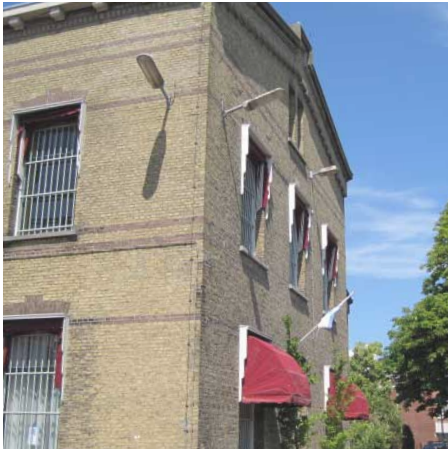
Afbeelding 11. Overzicht van het exterieur van bouwdeel G, gezien richting het noorden. Op zowel de oost- als de zuidgevel zijn grote armaturen aangebracht. Foto: Dhr. Bastiaans, Monumentenwacht Overijssel en Flevoland / Drenthe 2009.
