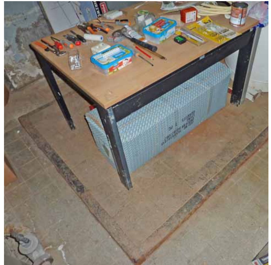
Afbeelding 38. Zicht op de verhoogde installatievloer. Deze vloer bestaat uit geperforeerde stalen profielen, ten behoeve van de ventilatie met daarop geplaatste stalen tegels. In bouwdeel D komt in het noordelijk deel van de binnenplaatsvleugel dezelfde vloer voor.
