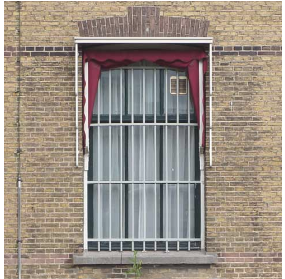
Afbeelding 63. Zicht op één van de vensters. De vensters zijn nu voorzien van markiezen met een houten luifeltje. Overwogen zou kunnen worden het traliewerk te verwijderen en de louverluiken te herstellen.
