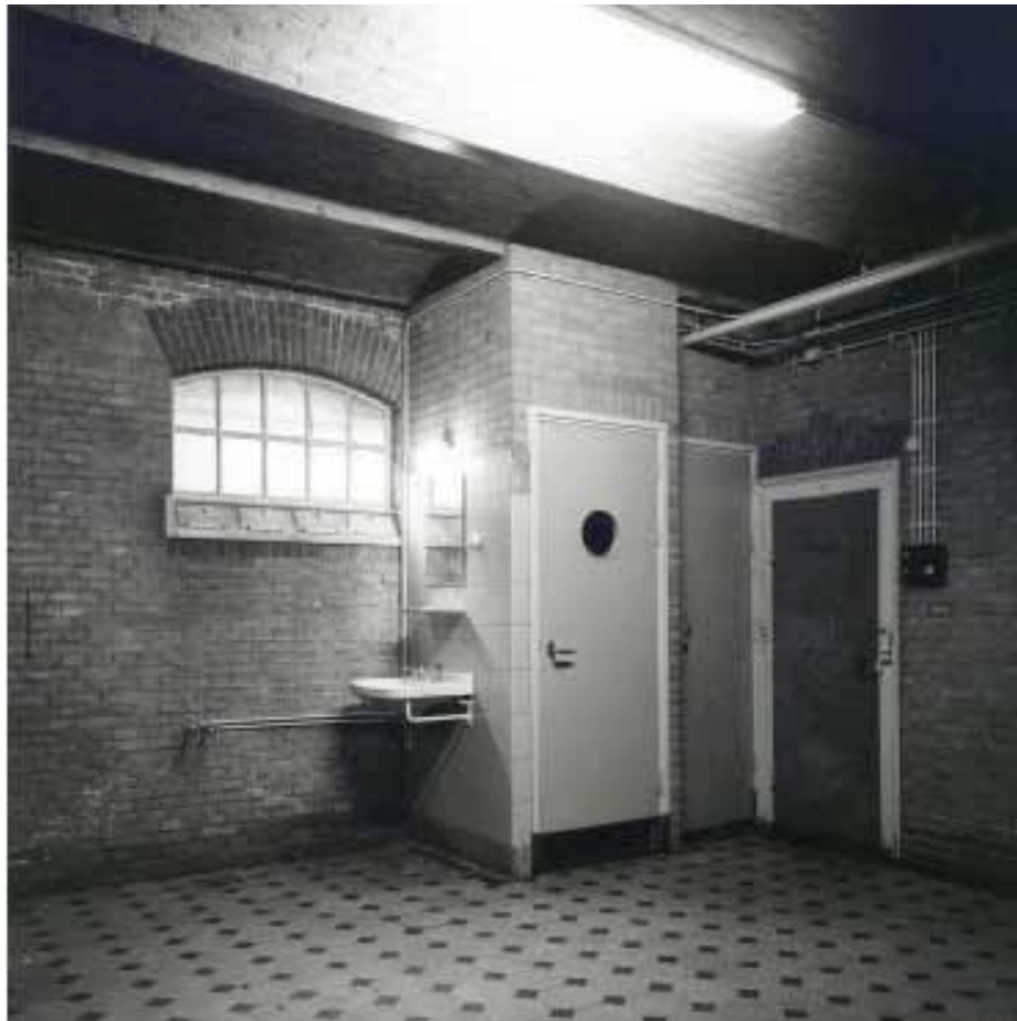
Afbeelding 31. Overzicht van ruimte B0.31 gezien richting de voorgevel in februari 1983. ('De vroegere vrouwenafdeling in de B-vleugel van de voormalige Strafgevangenis.') De wanden waren nog niet wit gesausd en ook de tegelvloer was nog in het zicht. Het toilet bevond zich in de grootste van de twee ruimtes tegen de buitengevel (1965). De hanekam boven de celdeur en de segmentboog boven het buitenvenster zijn, net als in de voorgevel, in een donkerde – hoogstwaarschijnlijk rode – baksteen uitgevoerd. Foto: Collectie Beeldbank Leeuwarden, documentnr.: FDBLHSPLB075
