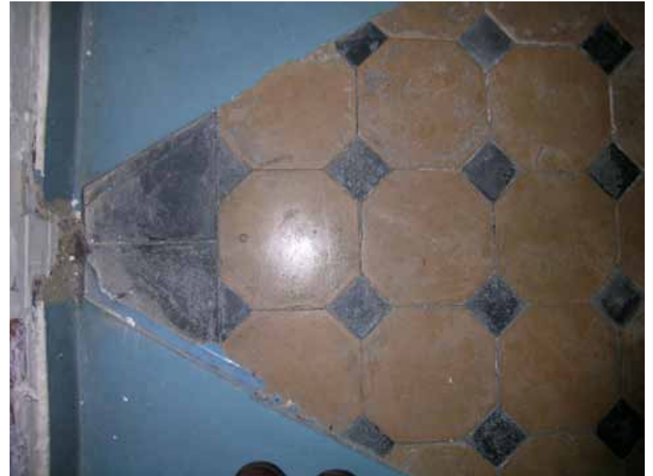
Afbeelding 61. Detail van de oorspronkelijke tegelvloer zoals deze onder de gietvloer van bouwdeel I nog aanwezig zal zijn (deze foto is genomen in bouwdeel F).
