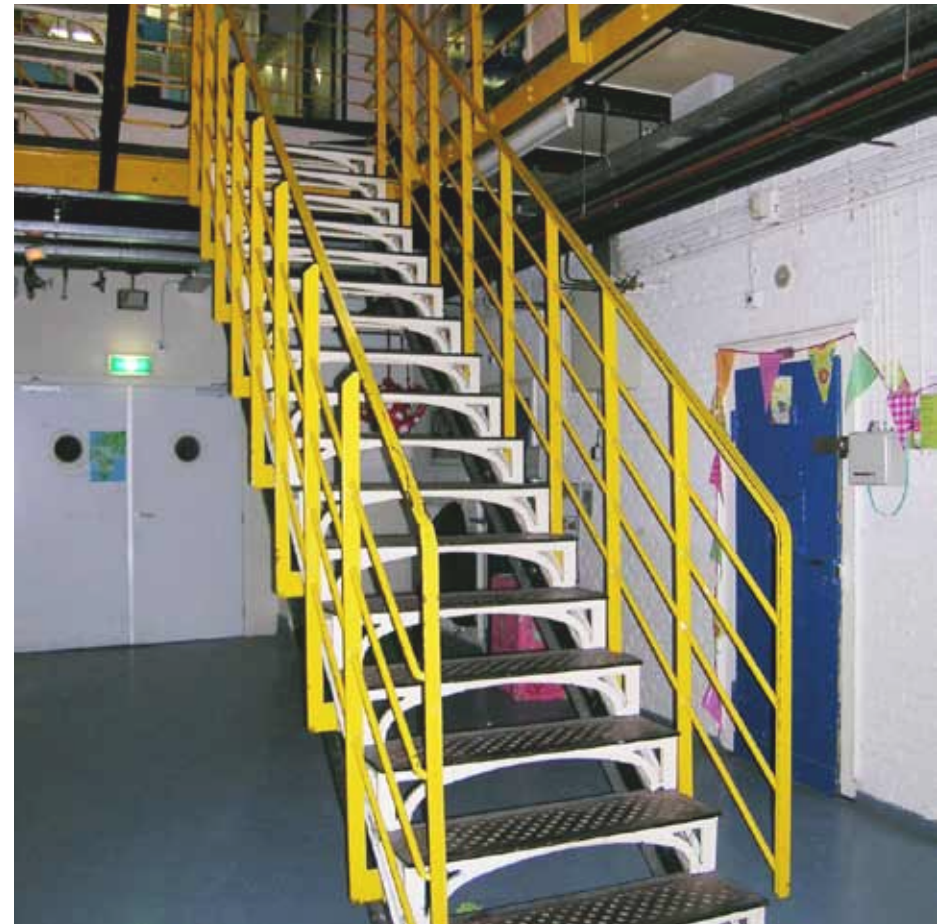
Afbeelding 21. Eén van de trappen in de cellenhal. De trappen (1894) bestaan uit op stalen I-profielen bevestigde gegoten ijzeren driehoekige opengewerkte segmenten. De secundaire (1988) leuningen bestaan uit verticale stalen strips met onder de T-vormige leuning een viertal horizontale ronde staven (rond 2 cm). Oorspronkelijk waren hier leuningen met slechts 2 horizontale tussenstaven (vergelijk Afbeelding 29).
