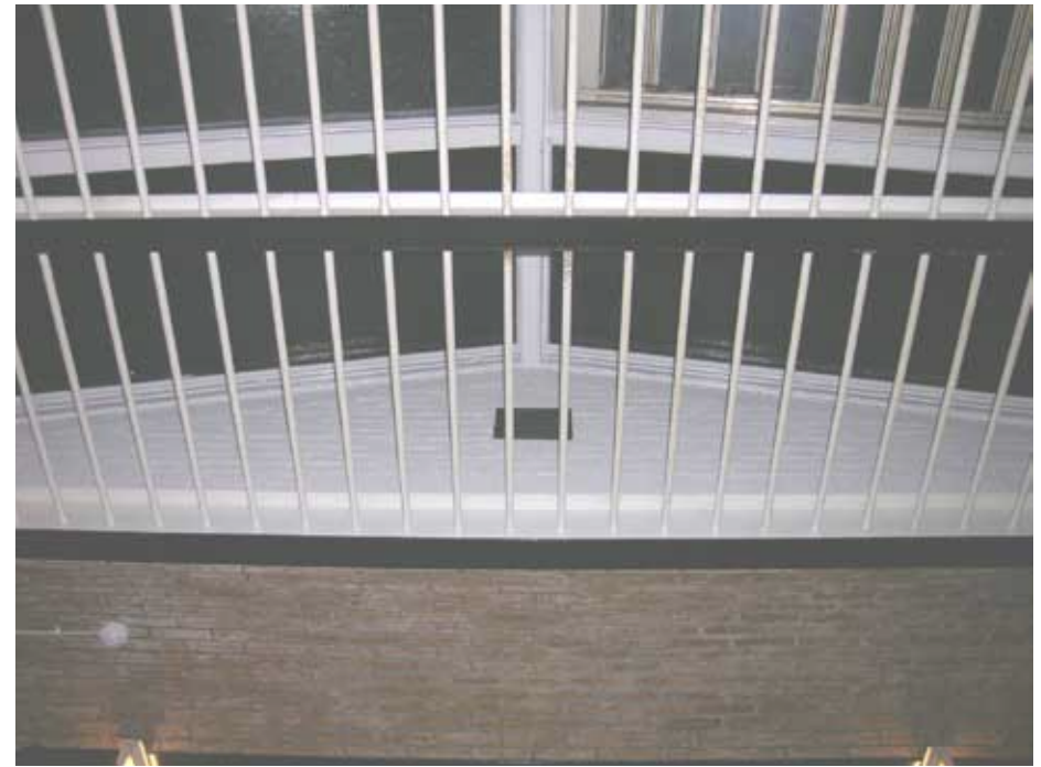
Afbeelding 23. Zicht op de onderzijde van één van de twee daklichten. Dwars op de doorgaande I-profielen van de truggewelfjes zijn ijzeren staven bevestigd met een onderlinge afstand van 15 cm. De kopschotten bestaan uit wit gesausd schoon metselwerk met gesneden voegen. Aan één zijde zijn twee van de vier ramen voorzien van ventilatieschoepen, de overige ramen bezitten draadglas.
