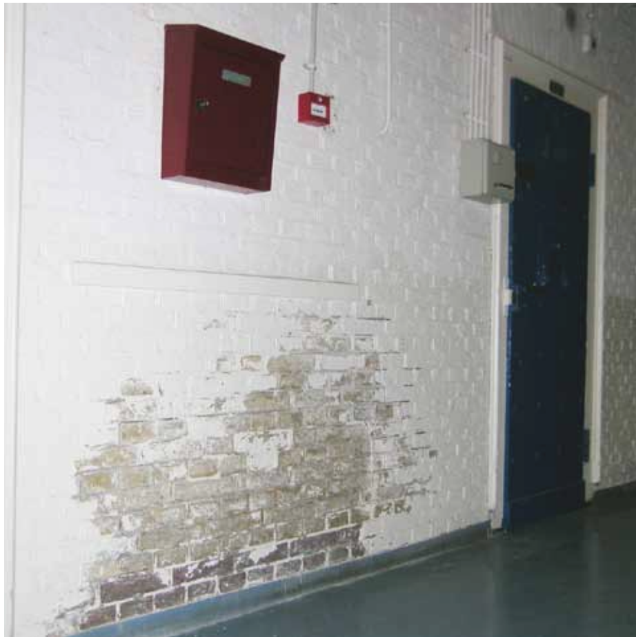
Afbeelding 20. Detail van de onderzijde van de wand van de cellenhal. De gemetselde wanden bestaan uit wit gesausde (1988) IJsselsteentjes in kruisverband met gesneden voegen. De onderste vier lagen - waarvan er twee achter de blauw geschilderde cementplint (0,8 x 7,5 cm) wegvallen – bestaan uit een afwijkende rode steen. De oorspronkelijke tegelvloer met hardstenen borders op de begane grond is afgewerkt met blauwe gietvloer (1997).
