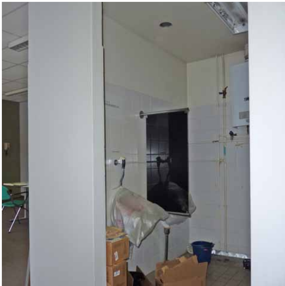
Afbeelding 11. Zicht in de voorruimte met twee toiletten (ruimten L0.17-18 en L0.24) van de sanitaire groep uit 1988.
